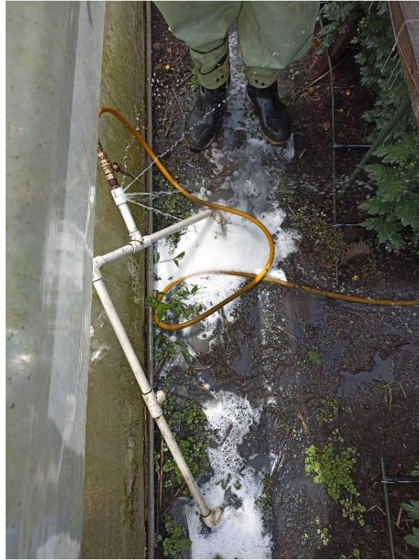
Figura 12. Aguilón en L dañado en una de sus uniones causando vertimiento de producto.
