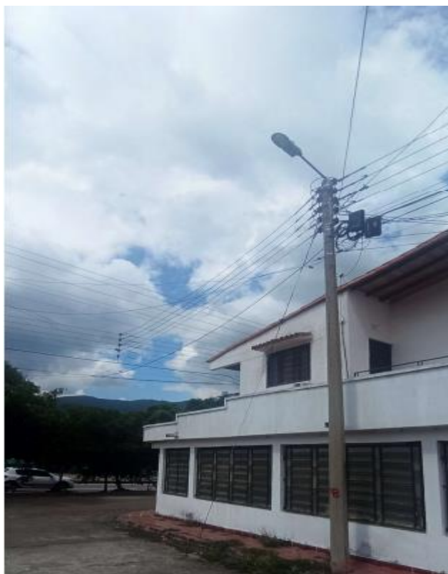
Ilustración 17 Puntos de baja tensión Fuente propia
