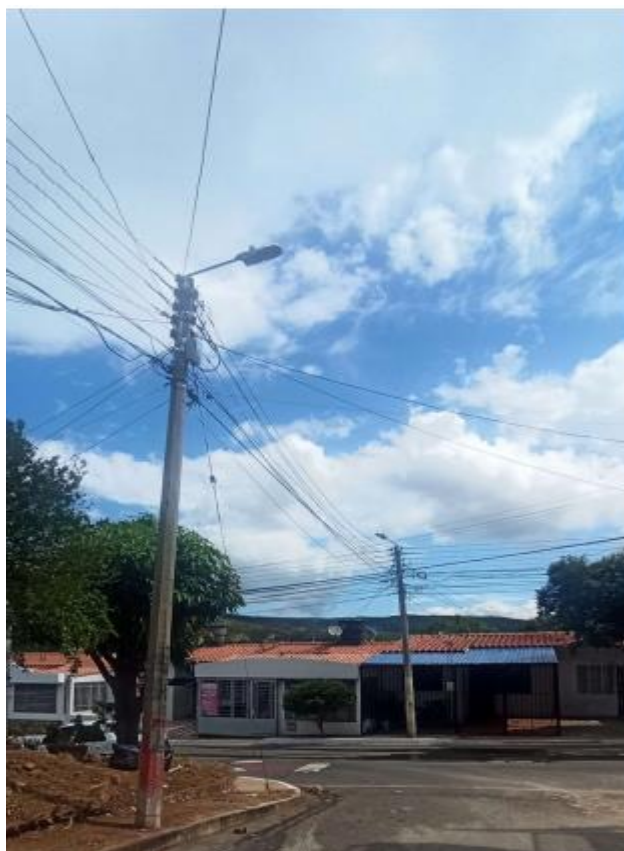
Ilustración 16 Puntos de baja tensión Fuente propia
