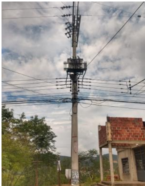
Ilustración 15 Puntos de baja tensión Fuente propia
