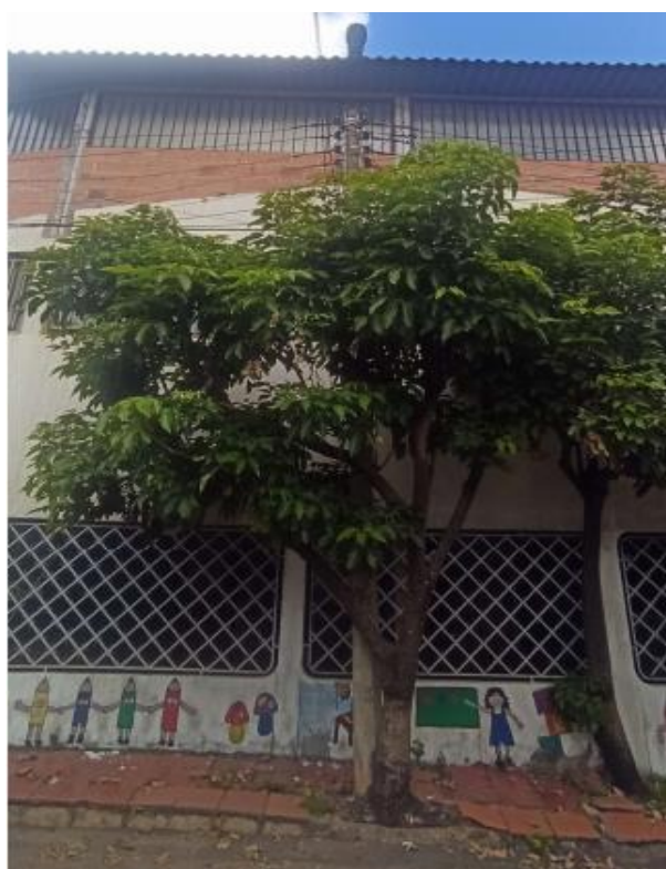
Ilustración 18 Puntos de baja tensión Fuente propia
