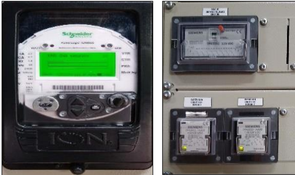
Figura 30. Medidor, relé 86 y relés supervisores. [15]
