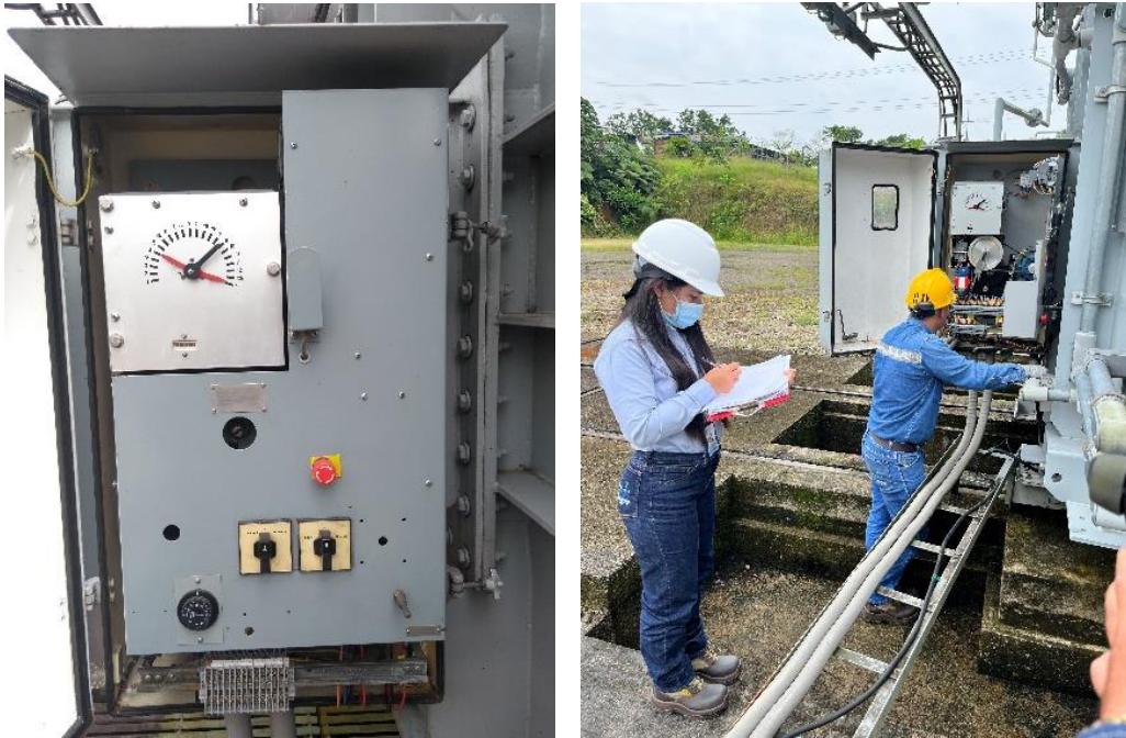
Figura 51. Conmutador y posición del Tap. Autor
