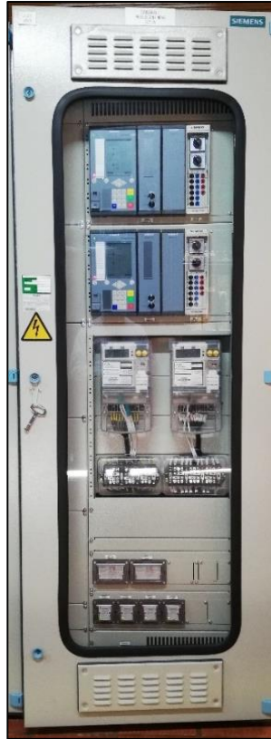
Figura 20. Tablero de control y protección subestación El Yarumo. [15]
