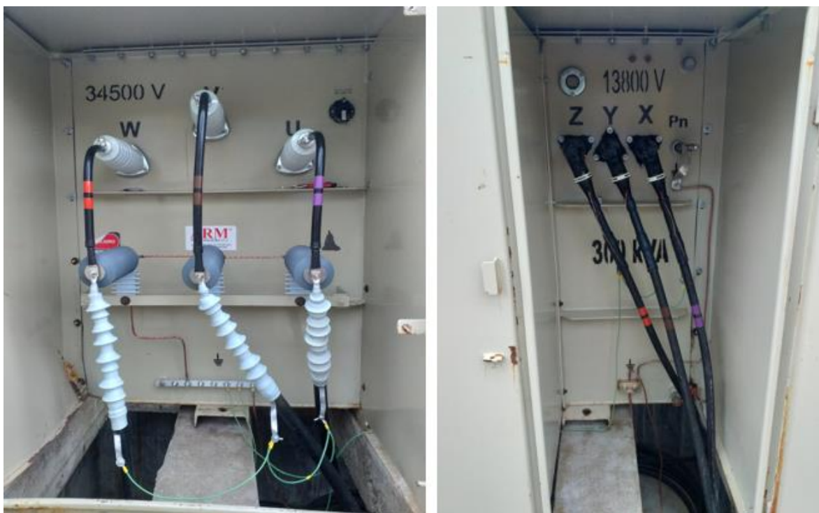
Imagen 66. Resultado de la instalación eléctrica parte interna del transformador de 300KVA
