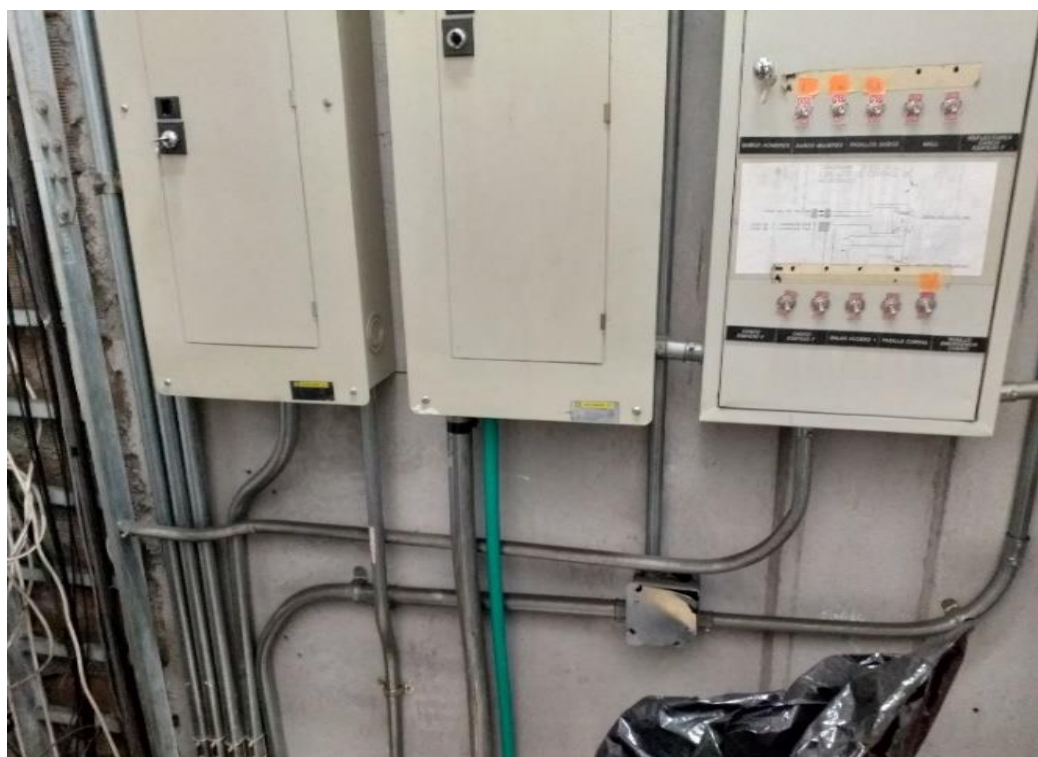
Imagen 15. Tableros y canalizaciones sin señalización
