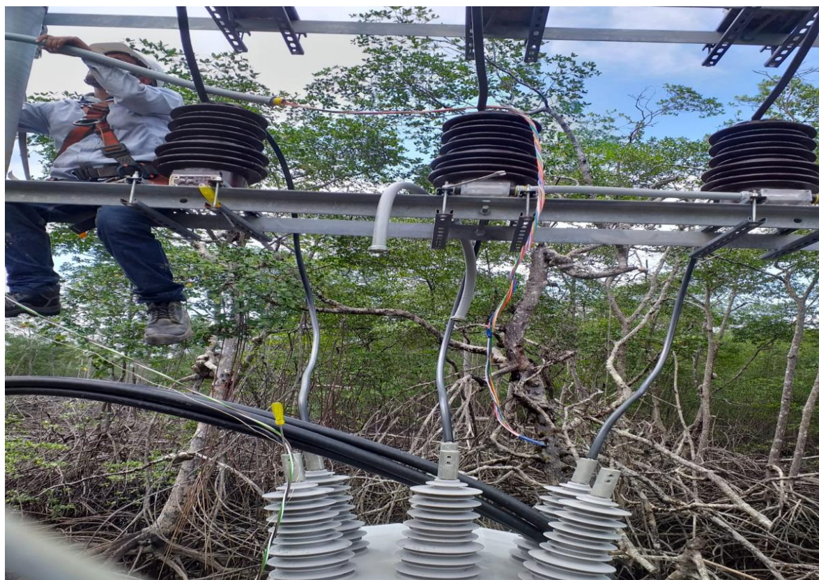
Imagen 39. Conexión de equipos de medida TPs y TCs
