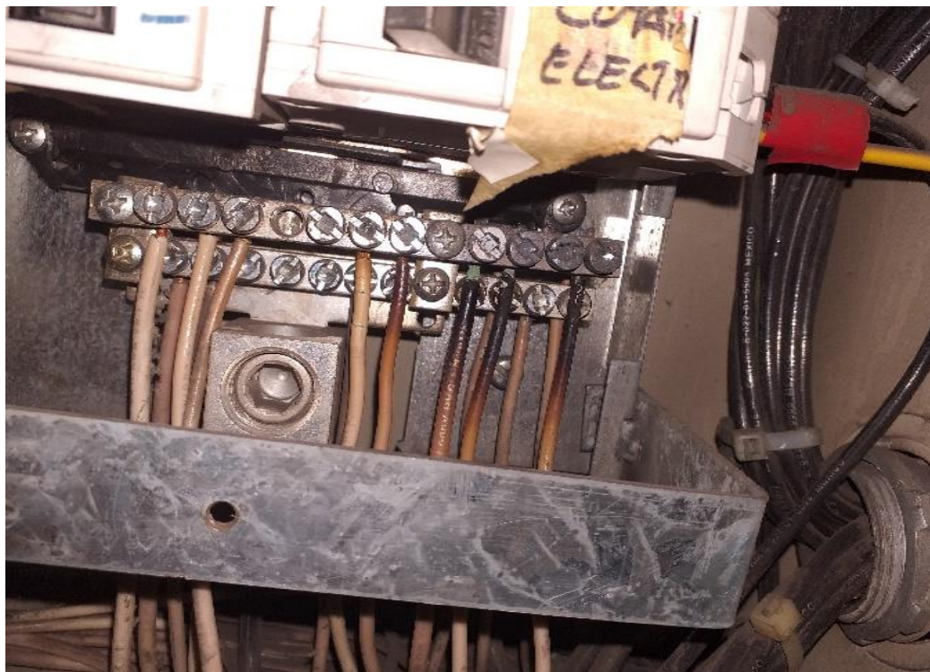
Imagen 13. Conductores en mal estado
