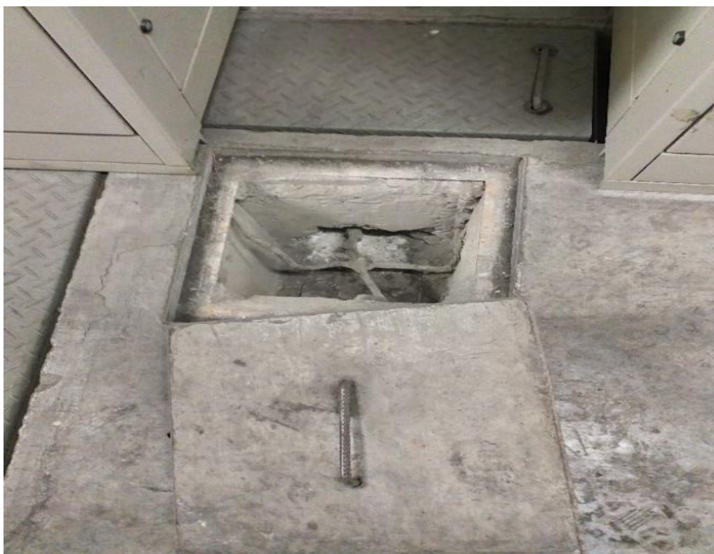
Imagen 18. Sistema de puesto a tierra antes del mantenimiento
