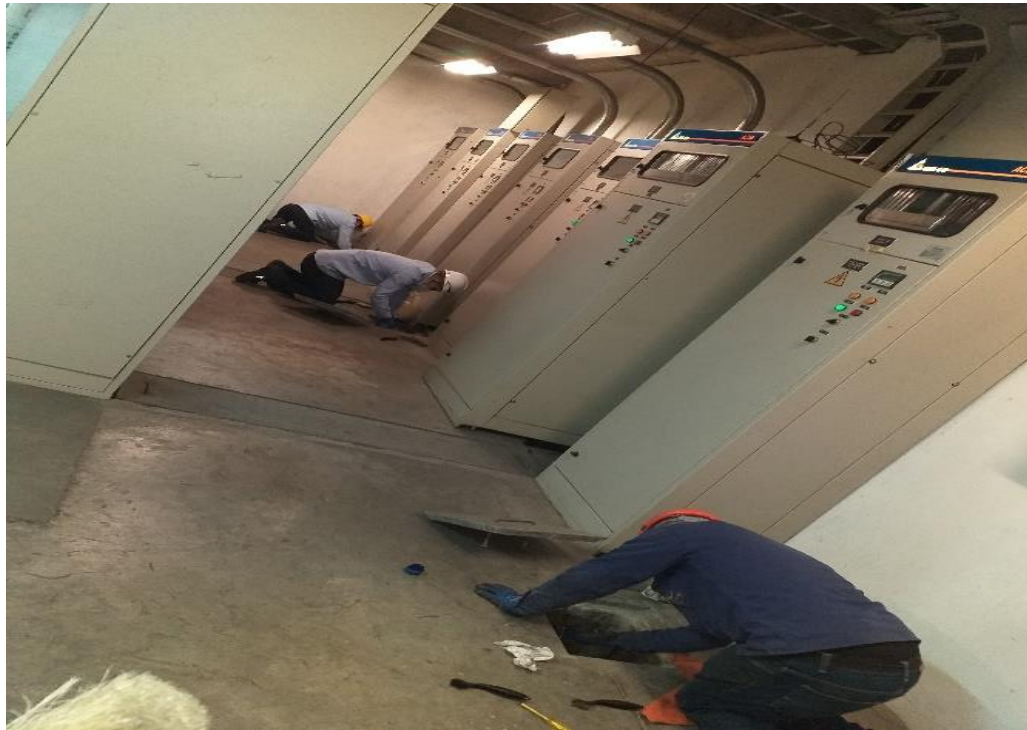
Imagen 19. Mantenimiento a sistema de puesto a tierra
