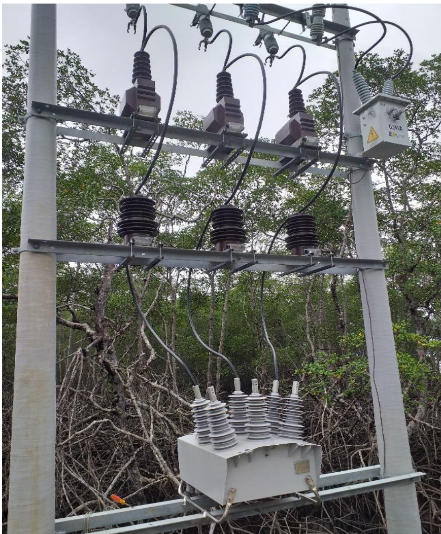
Imagen 20. Equipos conectados en la estructura de 34.5 KV
