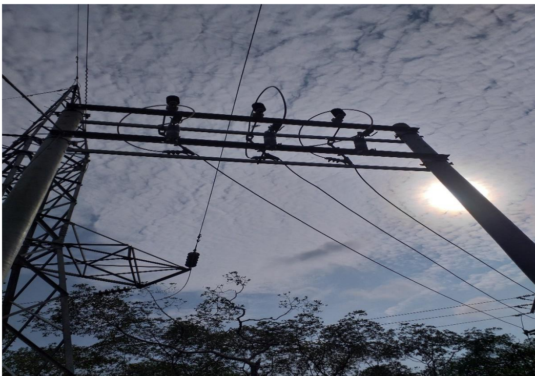
Imagen 23. Estructura para las líneas de 13.2 Kv con montaje de DPS y Cortacircuitos.
