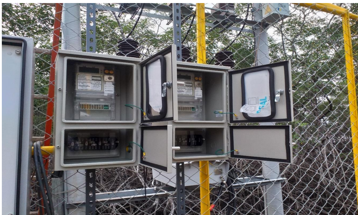
Imagen 35. Medidores y borneras de pruebas instalados en sus respectivos gabinetes.
