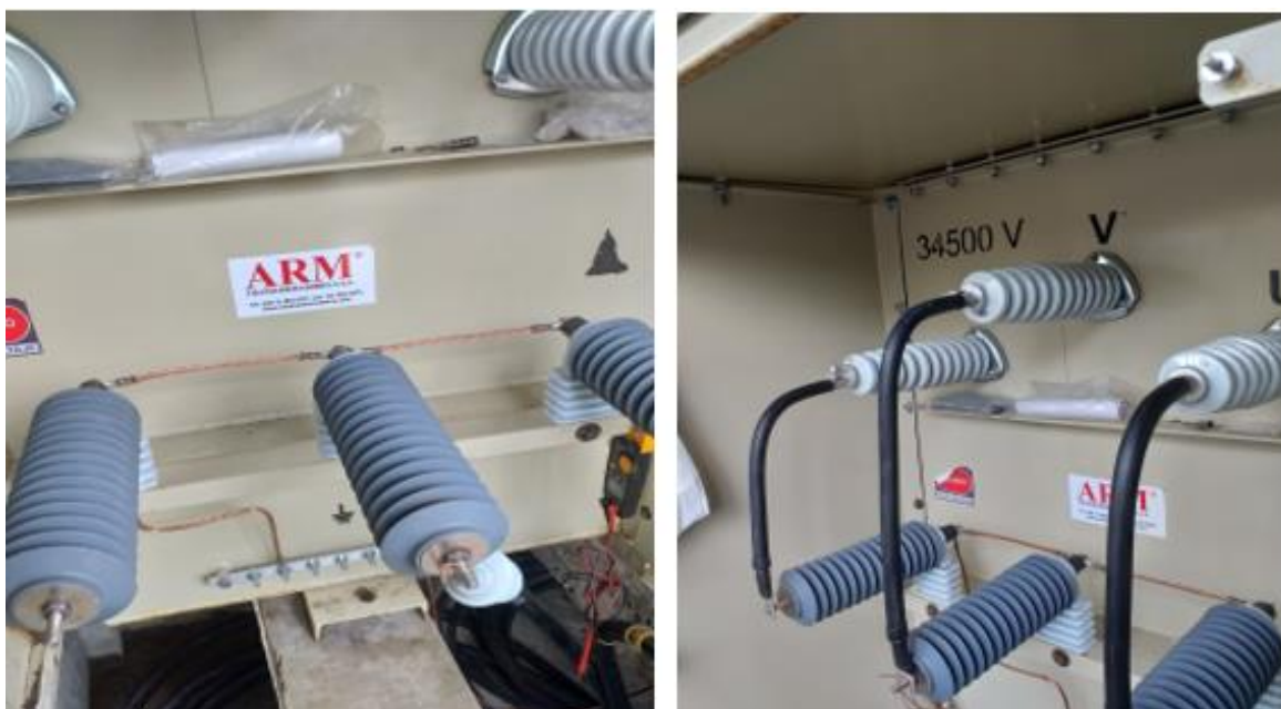
Imagen 53. Conexión a tierra de los DPS y conexión de los DPS a los bornes del transformador
