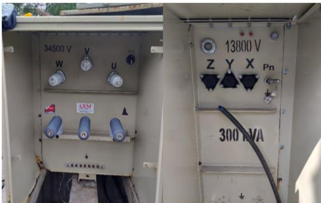
Imagen 22. Entrada y salida del transformador
