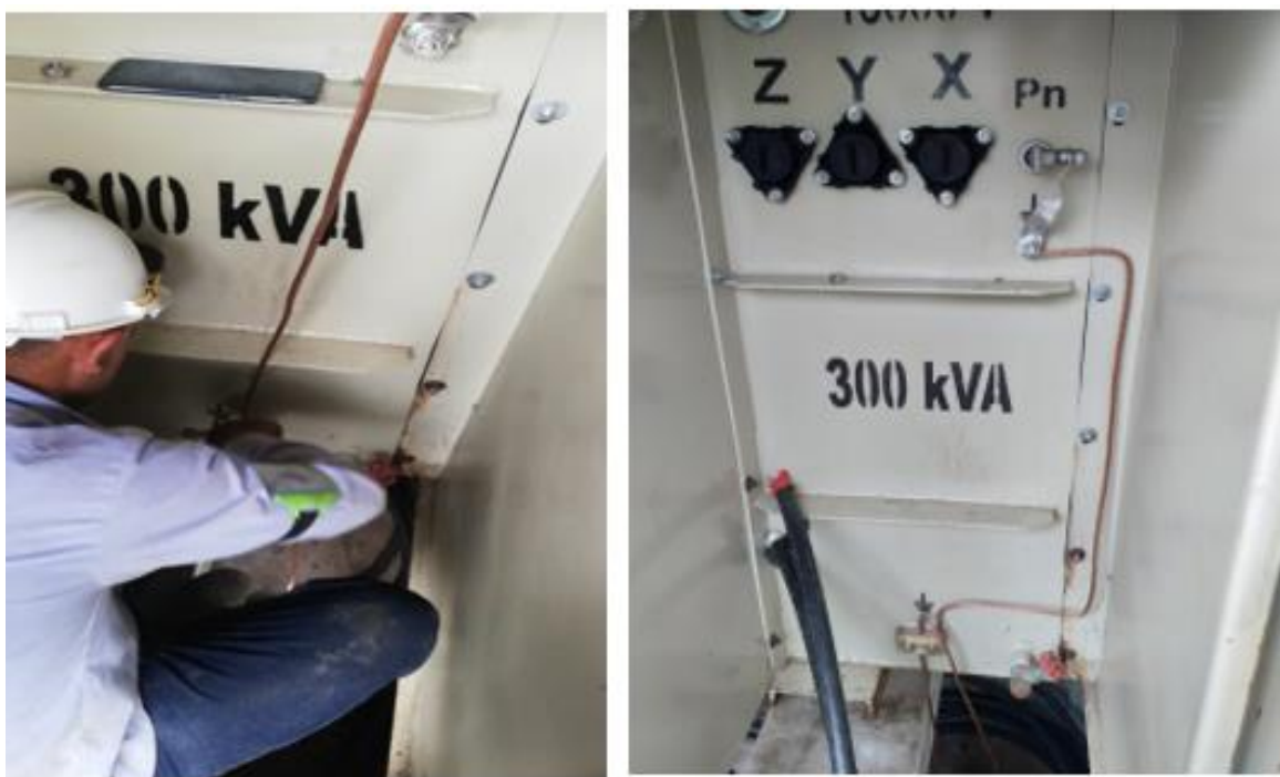
Imagen 51. conexión de sistema puesta a tierra
