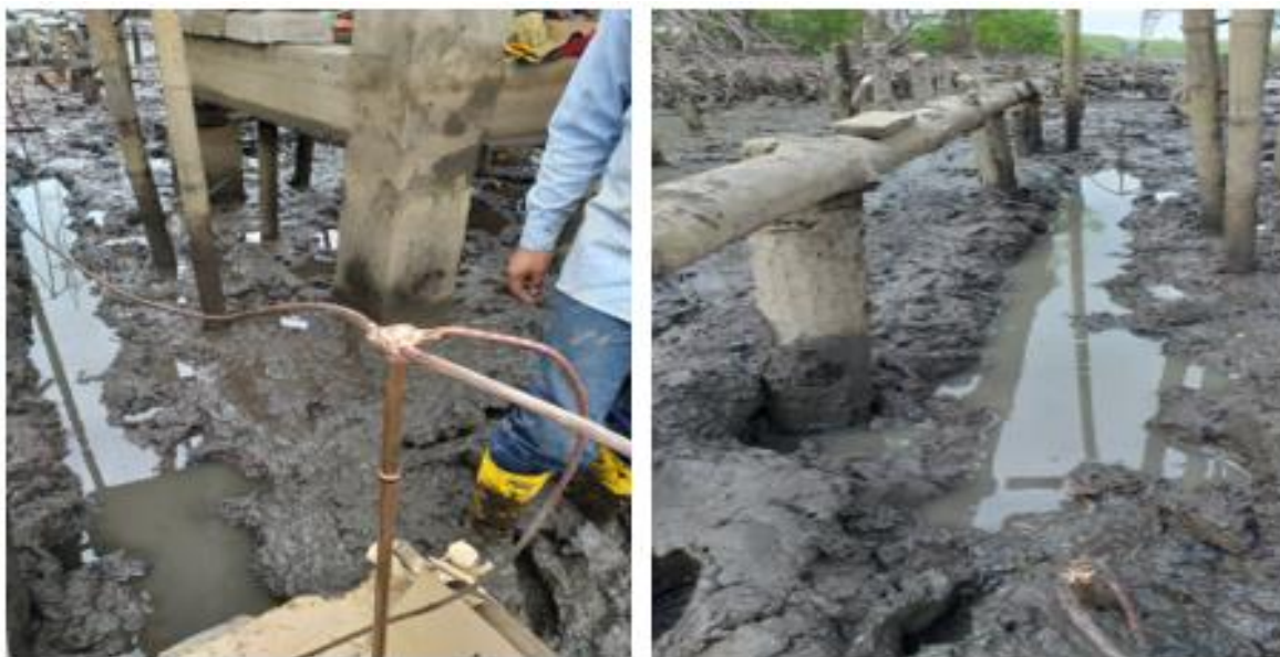
Imagen 68. Malla sistema puesta a tierra
