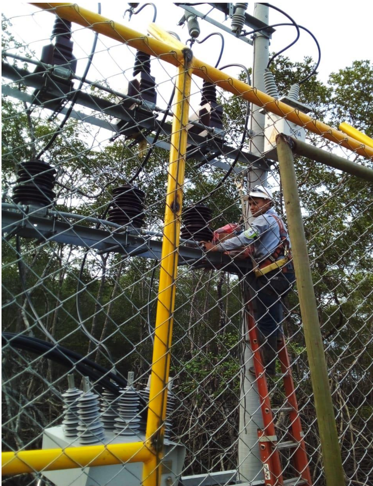
Imagen 41. Apoyo en la conexión de los equipos de medida TCs y TPs.
