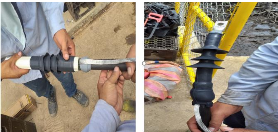
Imagen 47. Terminal premoldeados exteriores para las líneas de 13.2Kv
