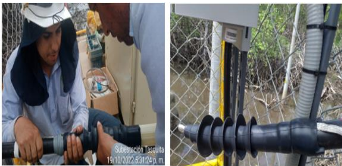
Imagen 50. Terminales premoldeados exteriores para la entrada del transformador 34.5Kv
