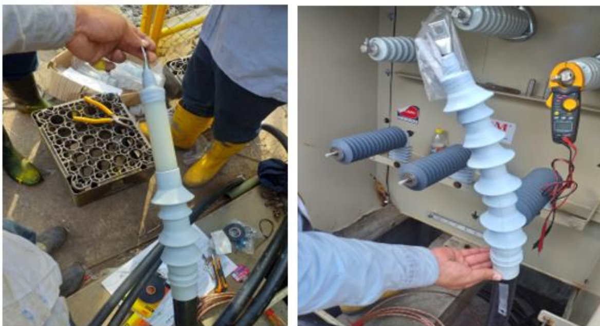
Imagen 52. Terminales premoldeados interiores para la entrada del transformador 34.5Kv
