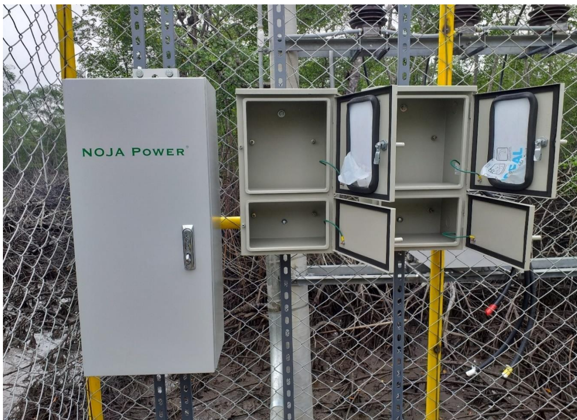
Imagen 34. Tablero de control, gabinetes para los medidores y borneras de pruebas
