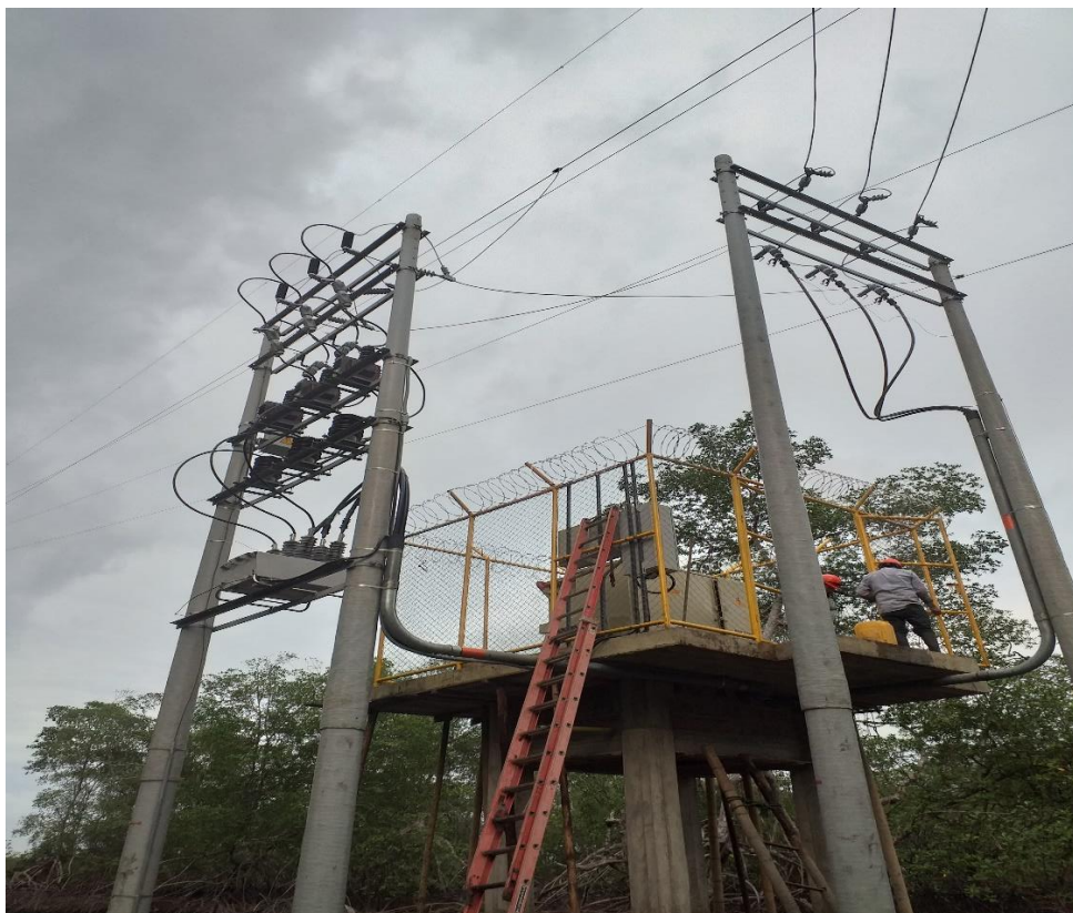
Imagen 71. Instalaciones eléctricas a subestación finalizadas. Mosquera Nariño
