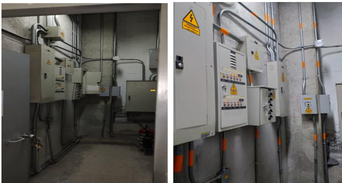
Imagen 63. Señalización a canalizaciones y símbolos eléctricos a tableros y equipos
