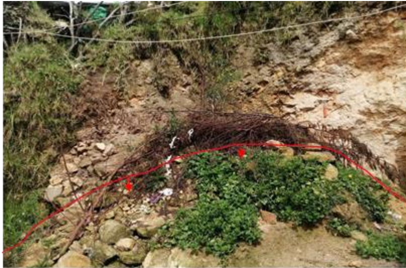
Fotografía 8 Deslizamiento traslacional sector Cristo Rey parte baja. Fuente: Autor, 2022
