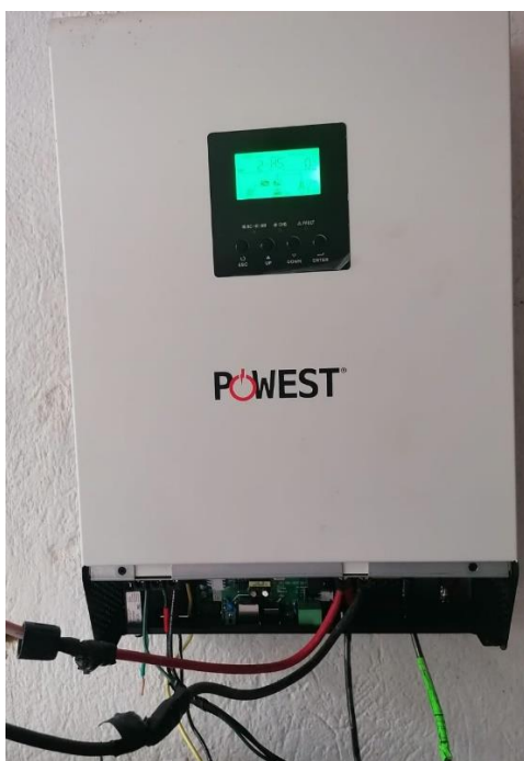
Ilustración 37. Inversor conectado al panel de prueba.
