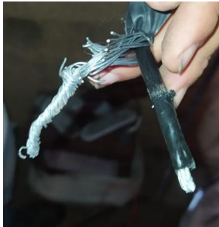
Figura 42. Daño en el cableado del panel al inversor del usuario U12
