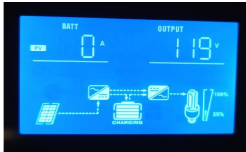
Figura 38. Pantalla del inversor donde se evidencia que no se envía corriente a las baterías
