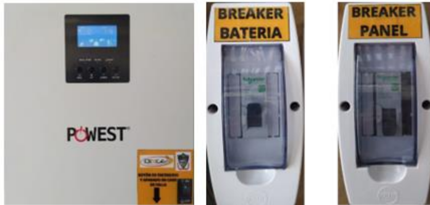
Figura 43. Adhesivos informativos en la instalación fotovoltaica
