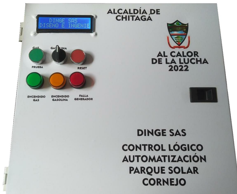
Figura 44. Panel de control de la planta de respaldo
