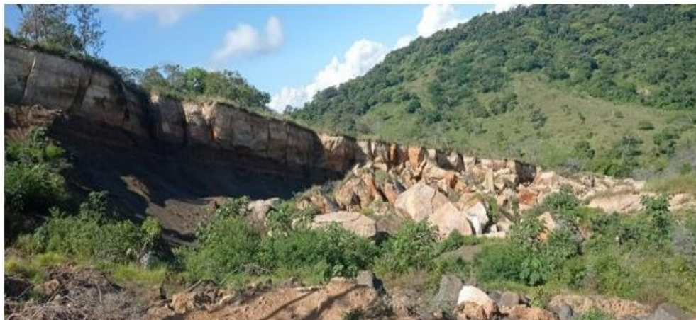
Figura 11. Deslizamiento en zona de estudio
