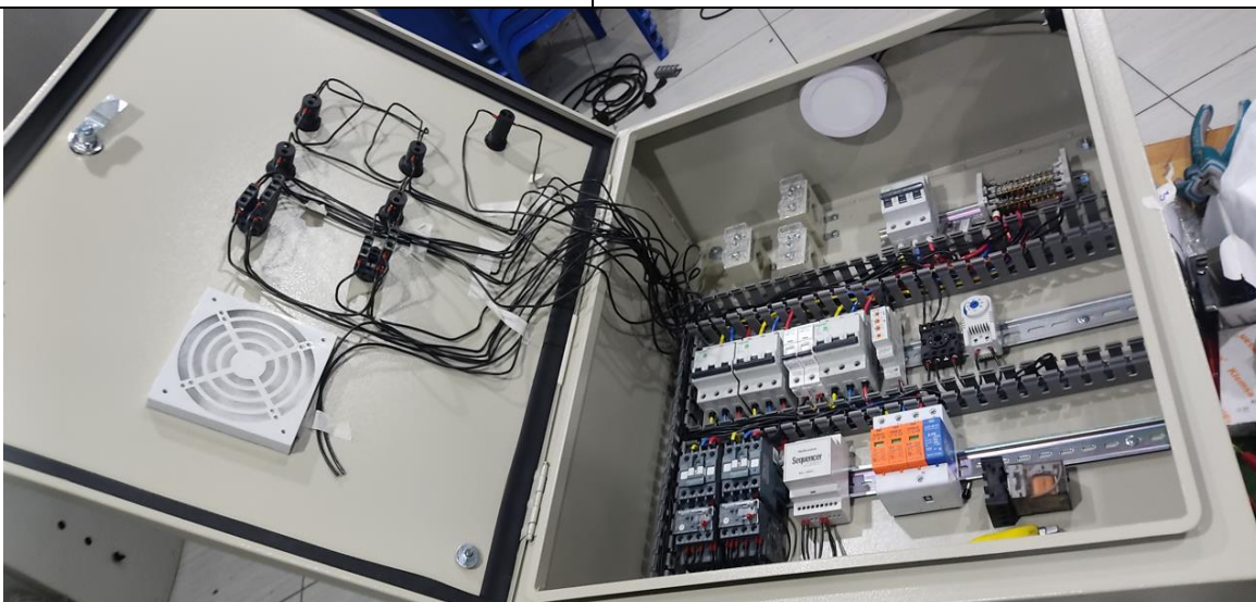
Figura 15.14 Proceso de elaboración de tablero eléctrico alternancia de 2 electrobombas
