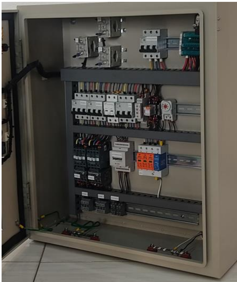
Ilustración 2.Marquillas en elementos y borneras de conexión a tablero eléctrico
