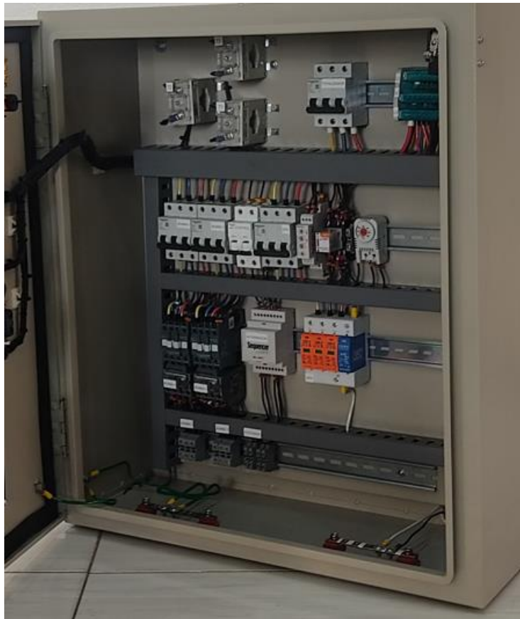
Figura 9.3 Marquillas en elementos y borneras de conexión a tablero eléctrico. Fuente: Propia
