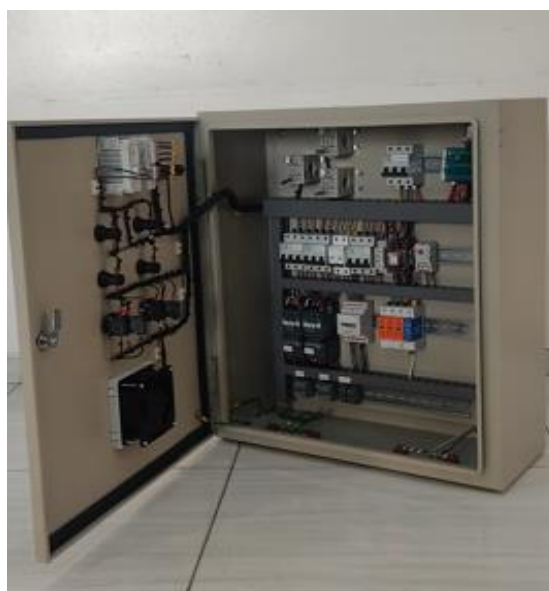
Figura 15.13 Tablero eléctrico alternancia de 2 electrobombas vista lateral
