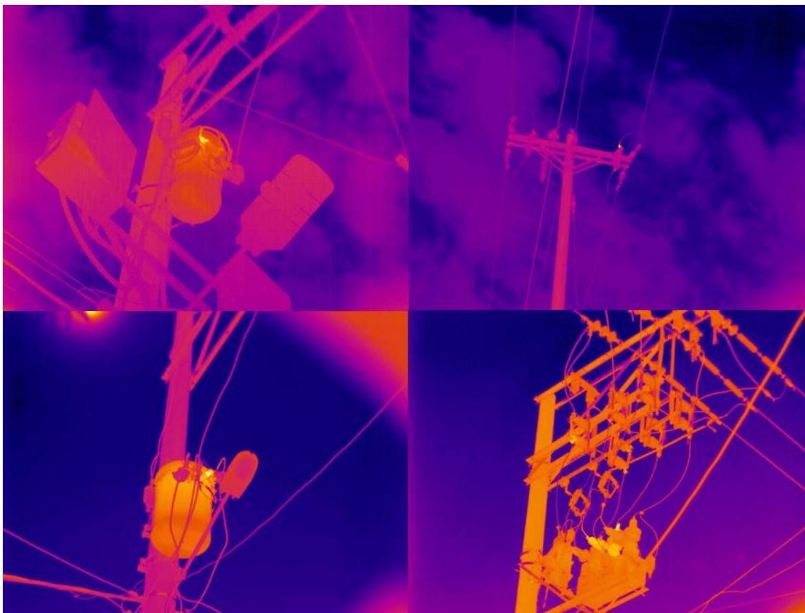
Figura 3. Diagnóstico termográfico a imágenes térmicas.
