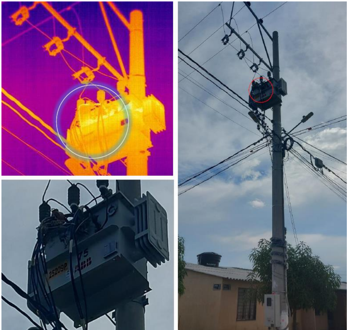
Figura 19. Transformador 5T02726 del circuito de alimentación primario Aguachica celda 2.
