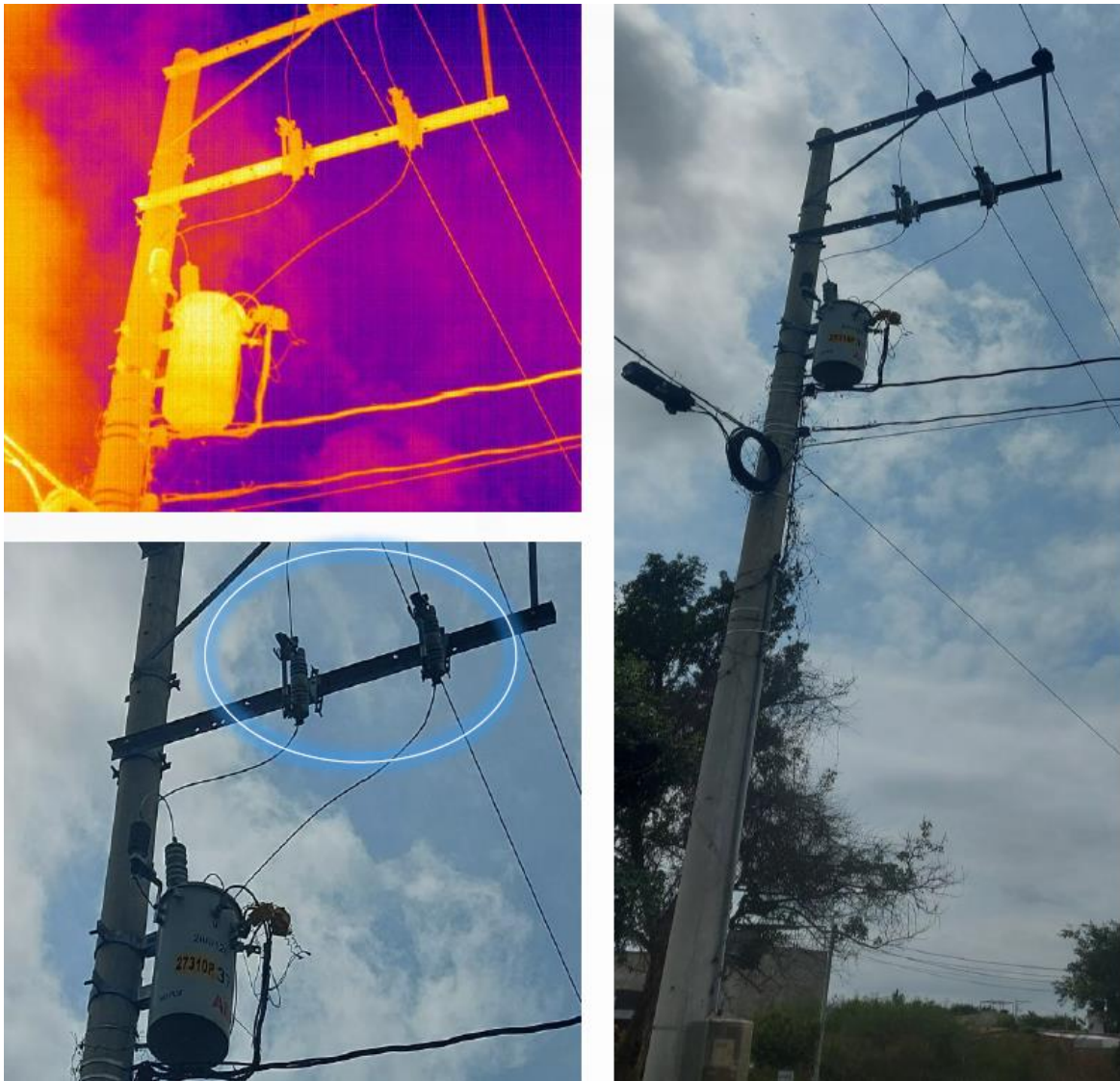
Figura 22. Transformador 5T02835 del circuito de alimentación primario Aguachica celda 2.
