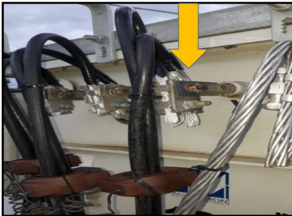
Figura 24. Transformador del circuito de alimentación primario Aguachica celda 2. Autoría propia
