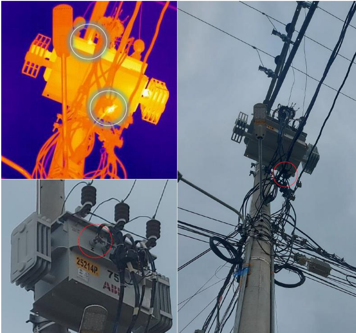
Figura 15. Transformador 5T02717 del circuito de alimentación primario Aguachica celda 2.
