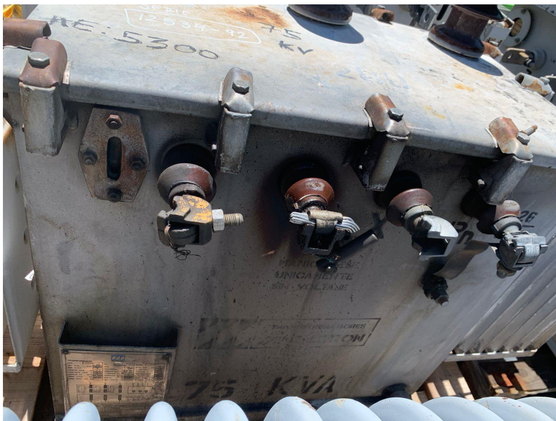
Figura 23. Transformador del circuito de alimentación primario Aguachica celda 2. Autoría propia
