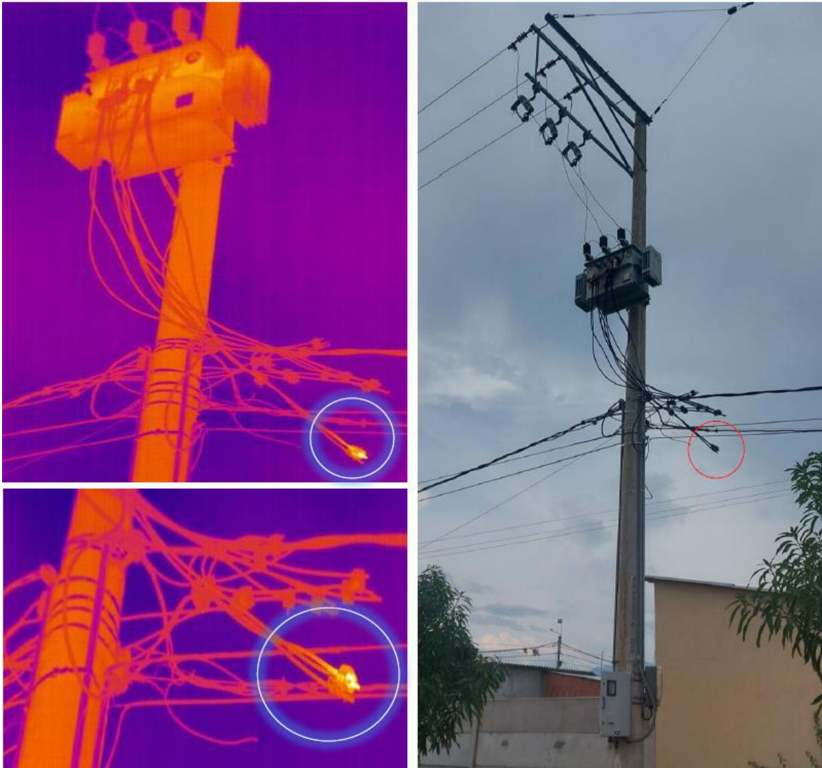
Figura 17. Transformador 5T02721 del circuito de alimentación primario Aguachica celda 2.
