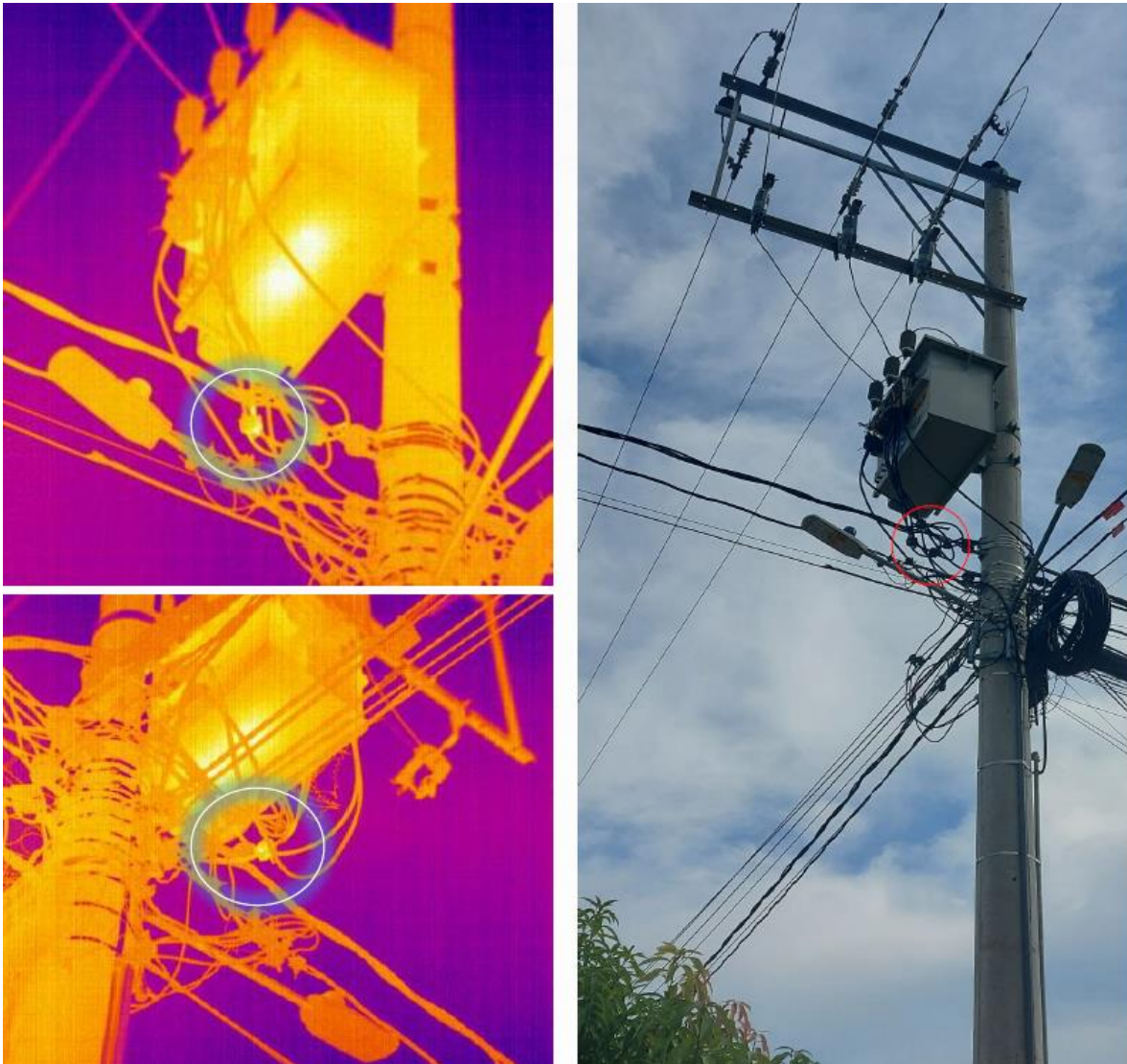
Figura 18. Transformador 5T02725 del circuito de alimentación primario Aguachica celda 2.
