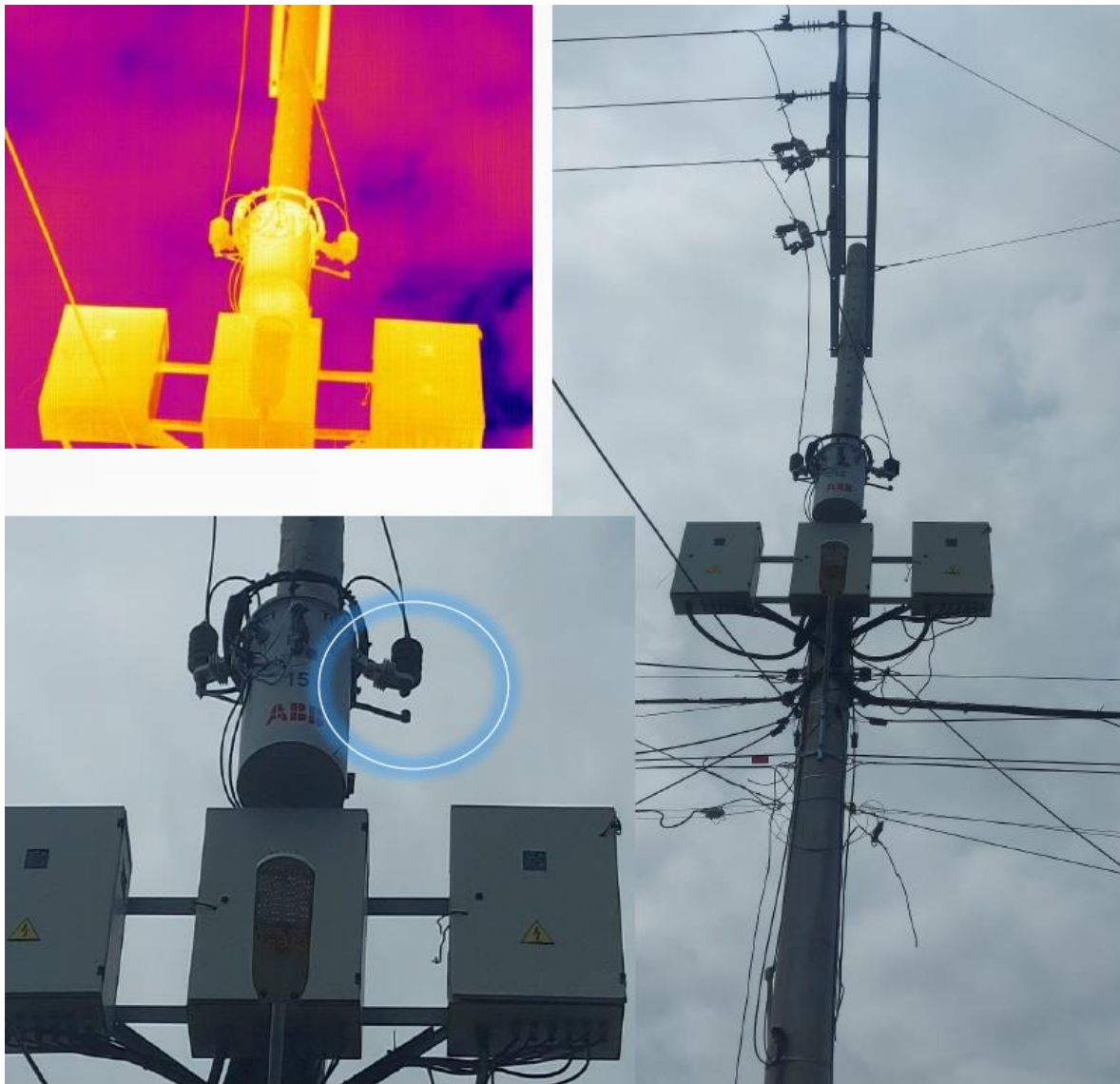
Figura 21. Transformador 5T02432 del circuito de alimentación primario Aguachica celda 2.
