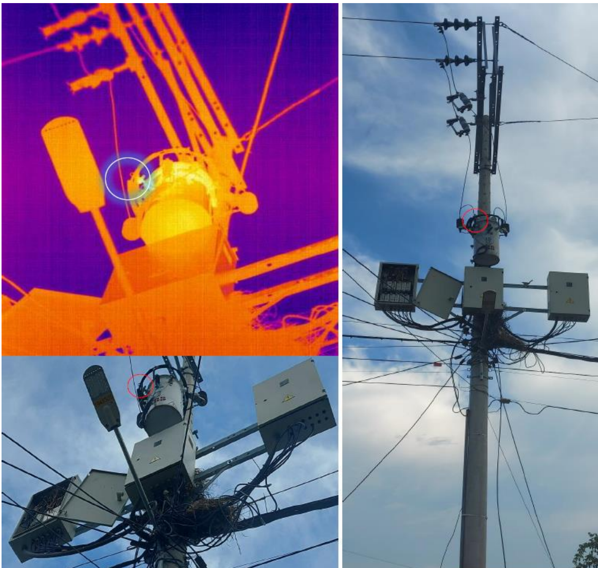
Figura 20. Transformador 5T02481 del circuito de alimentación primario Aguachica celda 2.
