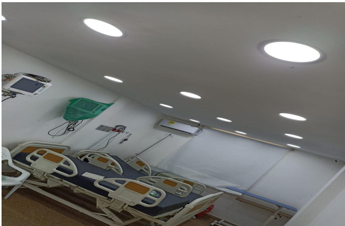
Ilustración 49. evidencia de iluminación, cuartos de recuperación
