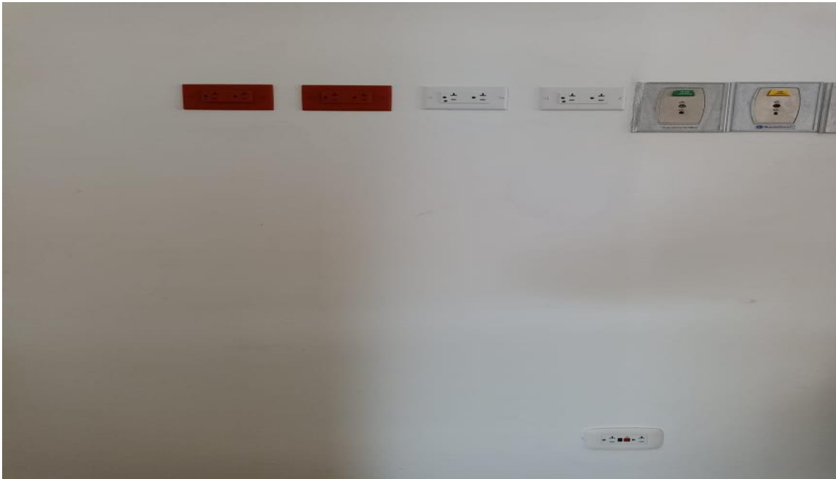
Ilustración 47. Evidencia, tomacorrientes de uso normal, crítico y de protección GFCI
