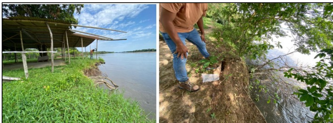
Figura 10: Socavación y pérdida de banca.
