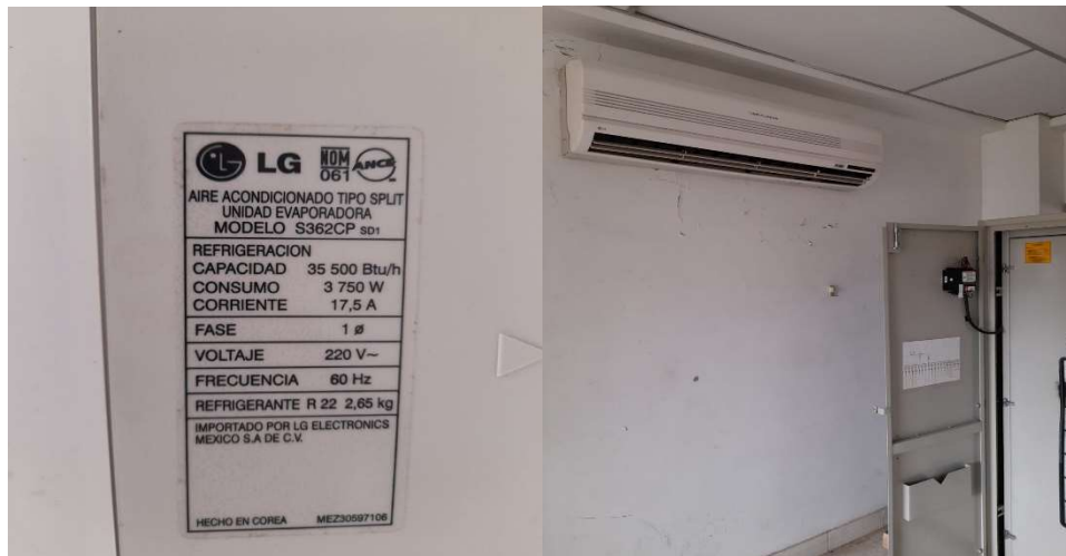
Ilustración 15 Placa característica de Aire acondicionado. Fuente: Autor
