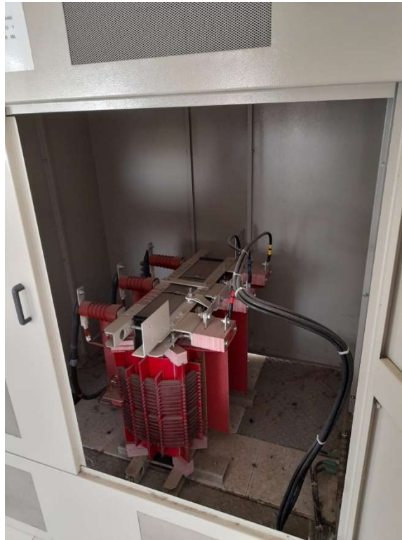
Ilustración 21 Transformador de 45KVA en seco que alimenta el sistema eléctrico de la subestación.
