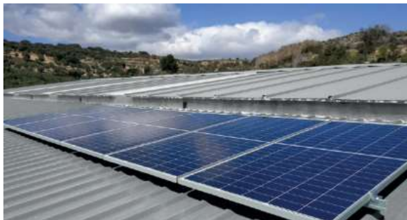
Ilustración 31 Estructura soporte de módulos solares. Fuente: Auto solar [24]
