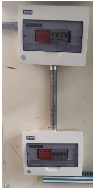
Ilustración 20 Protecciones en CD bajantes de los módulos fotovoltaicos
