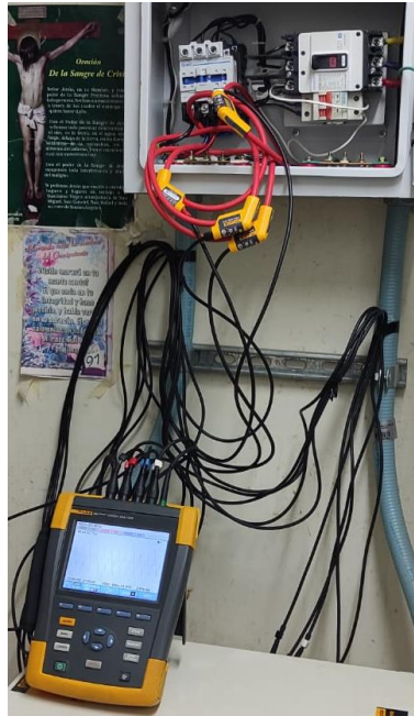
Ilustración 37 verificación funcionamiento del sistema fotovoltaico
