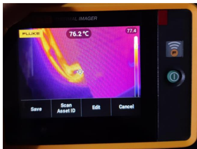
Ilustración 38 Verificación con cámara térmica del funcionamiento del transformador
