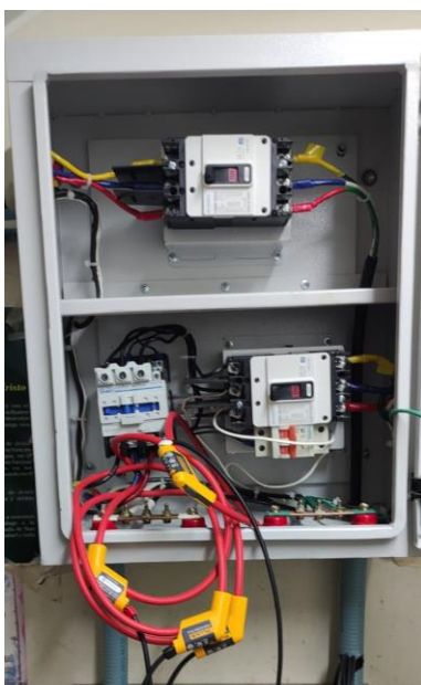
Ilustración 30 Instalación analizador de redes en el PCC
