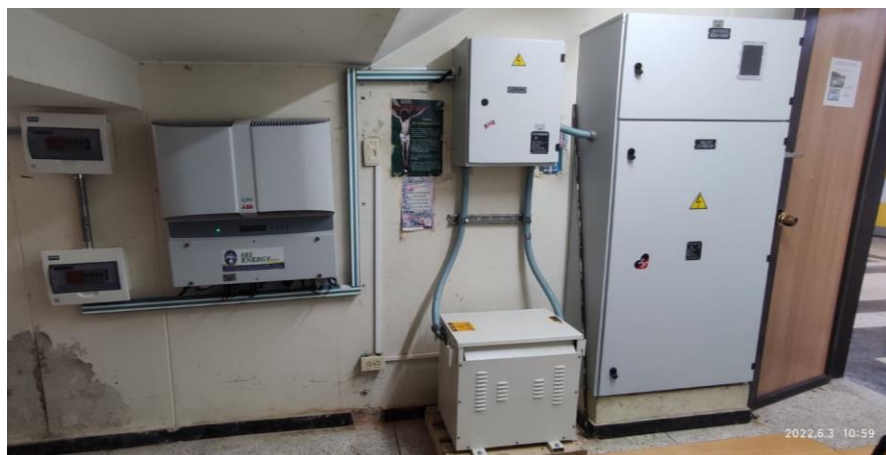
Ilustración 18 Área de control del sistema fotovoltaico
