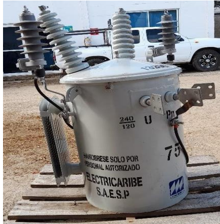
Ilustración 9. Transformador de distribución.
