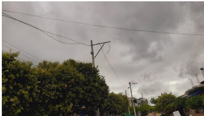
Anexo 10. Conductores en estructura sin tensionar.
