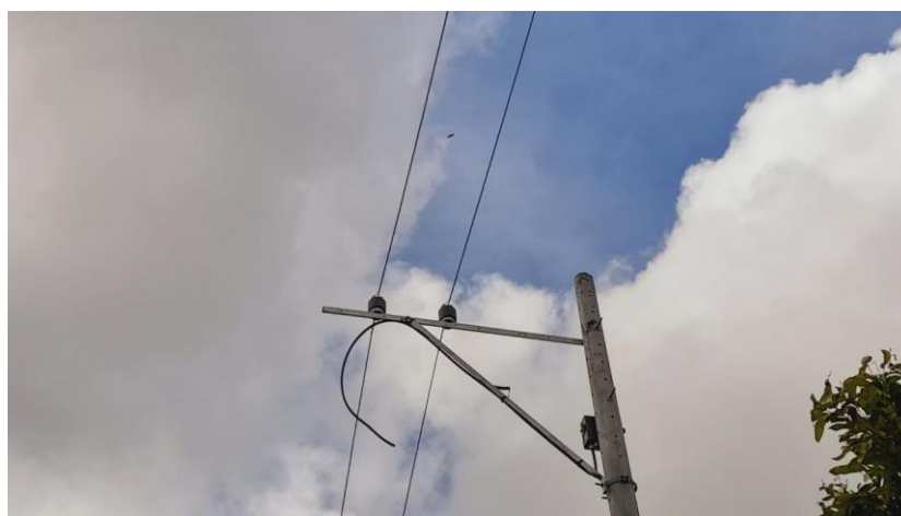
Anexo 12. Conductor de media tensión instalado en la estructura.
