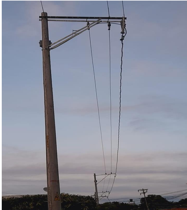
Anexo 18. Red de media tensión y baja tensión instalada.
