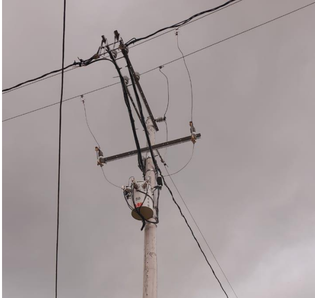
Anexo 17. Transformador instalado.
