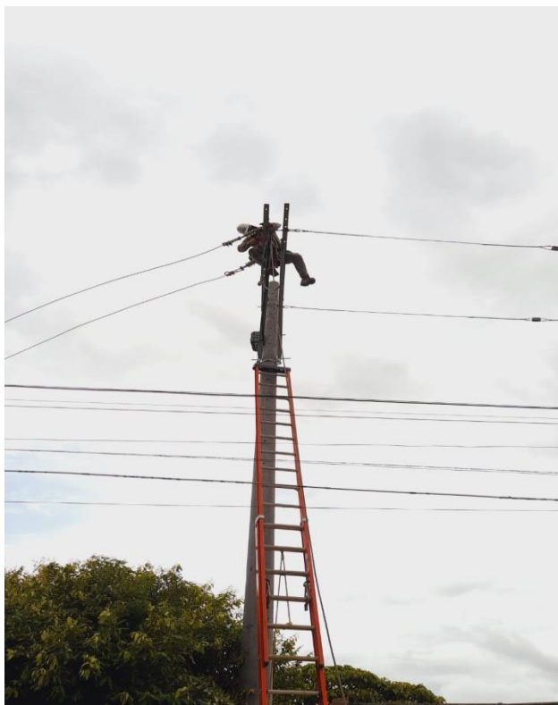
Anexo 11. fijación de línea de media tensión en cruceta.
