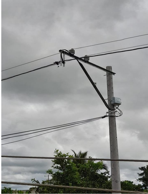
Anexo 13. Conductor de media tensión y baja tensión instalado en la estructura.
