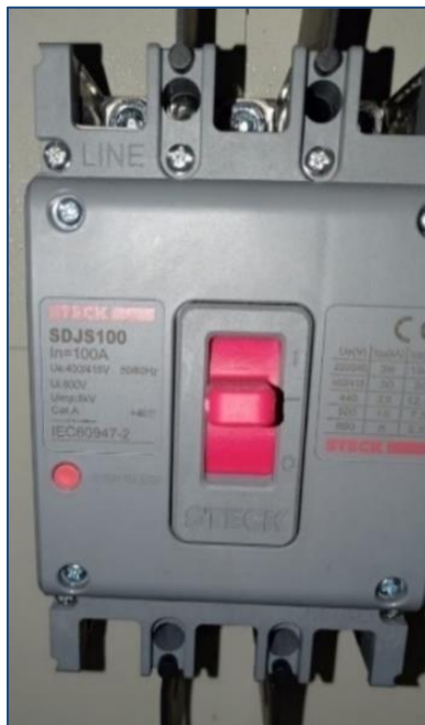
Ilustración 27. Interruptor Termo magnético 3X100A
