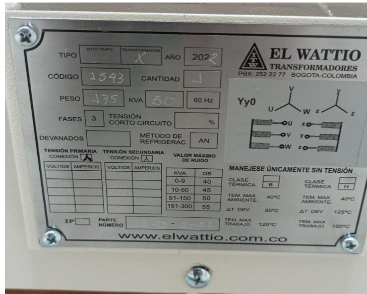
Ilustración 23. Placa técnica del transformador de 50KVA
