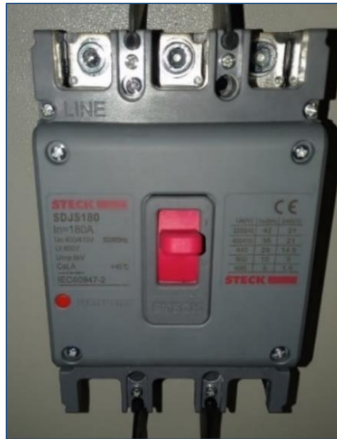
Ilustración 28. Interruptor Termo magnético 3X180A
