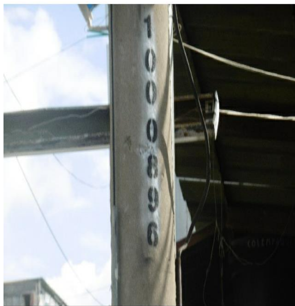
FIGURA 28 Apoyo ubicación transformador 14.
