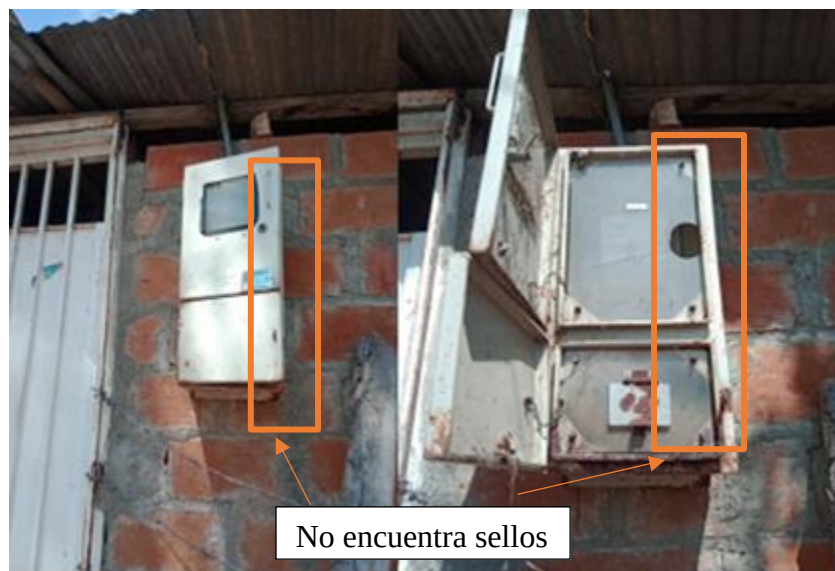
FIGURA 41 Caja metálica sin sellos
