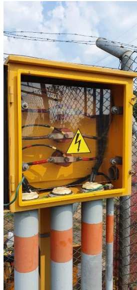
Ilustración 7 Caja de conexiones de subestación eléctrica
