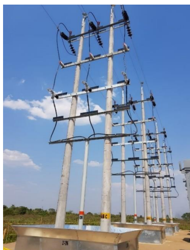
Ilustración 5 Cuchillas instaladas en pórtico de subestación eléctrica
