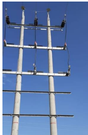
Ilustración 6 Apartarrayos ubicado en poste de subestación eléctrica
