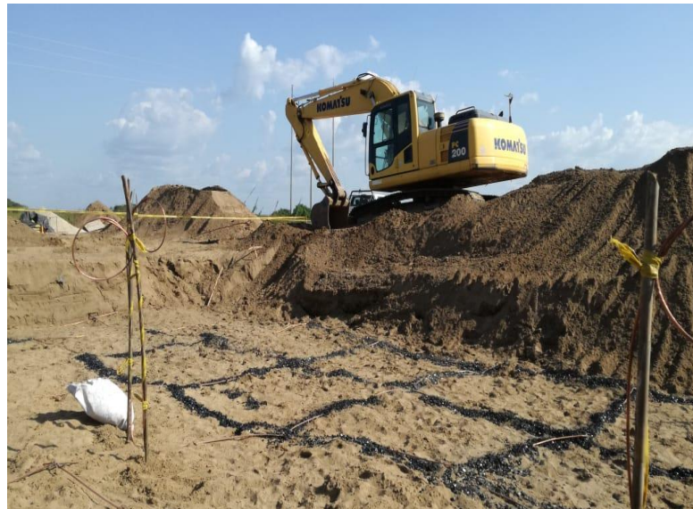
Ilustración 38 Empalmes y arreglos para la malla a tierra
