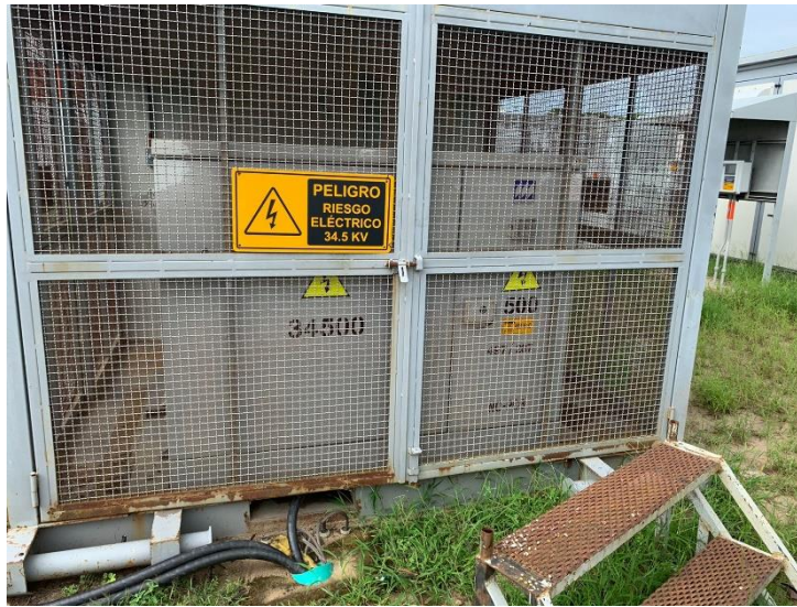
Ilustración 2 Transformador SDT (Step Down Transformer)
