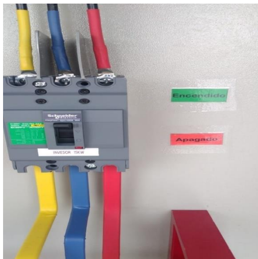
Ilustración 35 Protección del inversor de 15kWp
