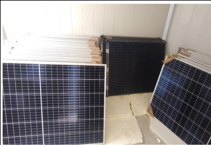
Ilustración 17 96 paneles solares almacenados, material que conforma el sistema fotovoltaico.
