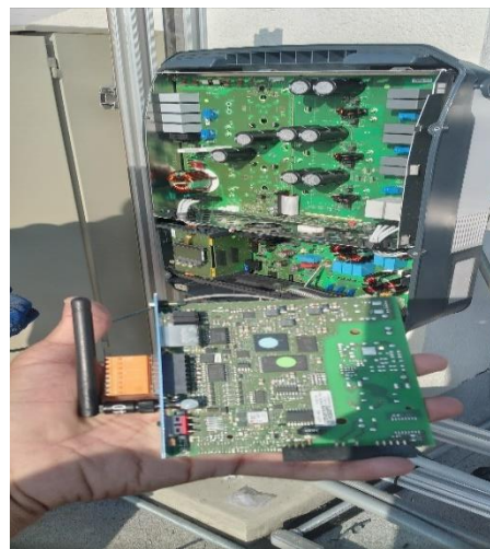
Ilustración 22 Data manager del inversor, es el encargado de la comunicación con el Smart meter, medidor de inyección cero y controlar los MPPT.
