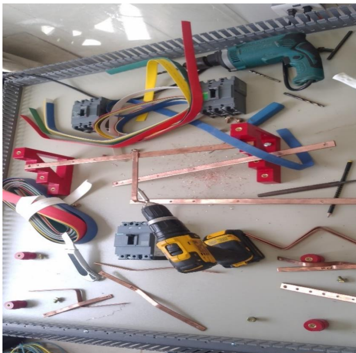
Ilustración 61 Materiales y herramientas para el gabinete fotovoltaico.
