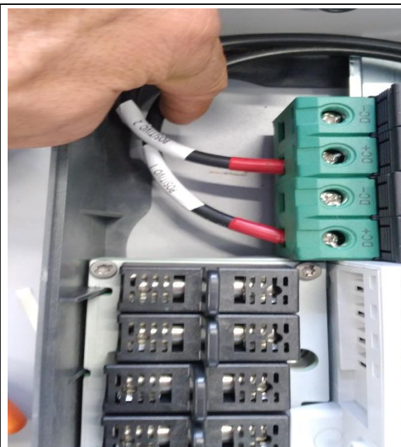
Ilustración 44 DPS internos de los inversores.
