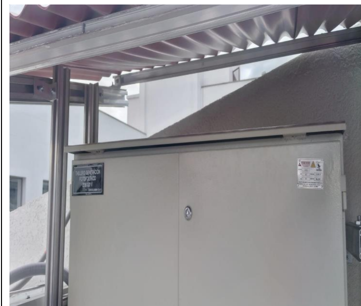
Ilustración 27 Tablero de generación fotovoltaico 208/120V
