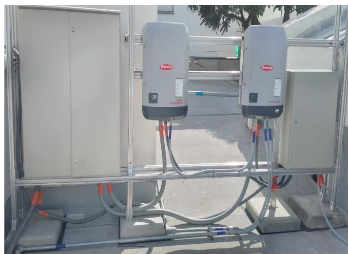
ilustración 24 inversor de 15kwp y 10kwp fijados en la estructura.
