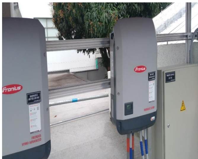
ilustración 23 inversor de 15kwp y 10kwp fijados en la estructura.
