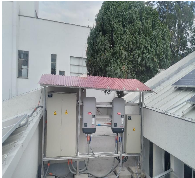
Ilustración 72 Gabinete fotovoltaico he inversores fijados en la estructura.
