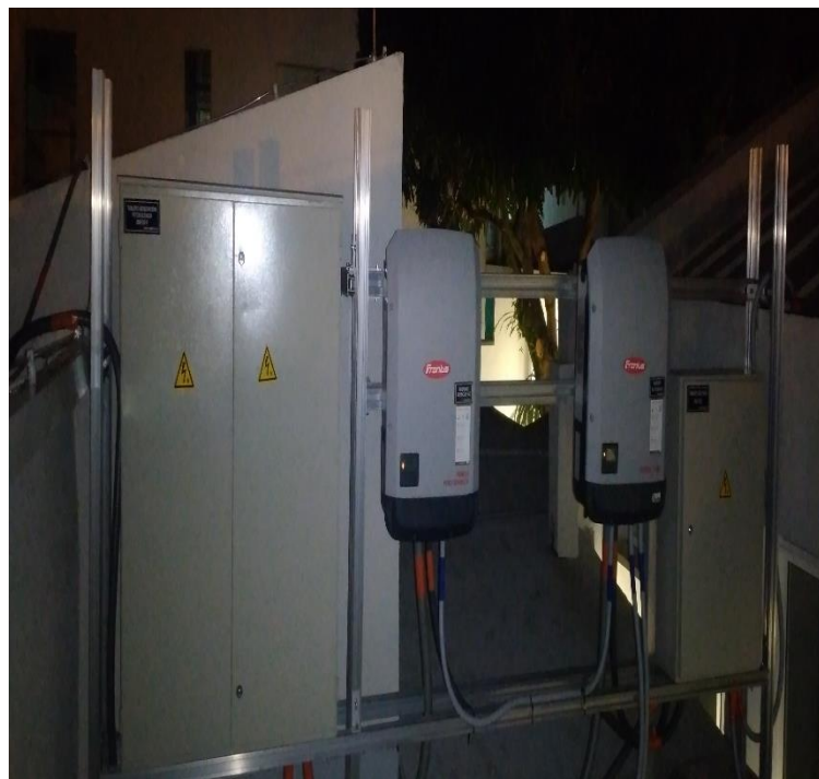
Ilustración 71 Inversores fijados en la estructura metálica.
