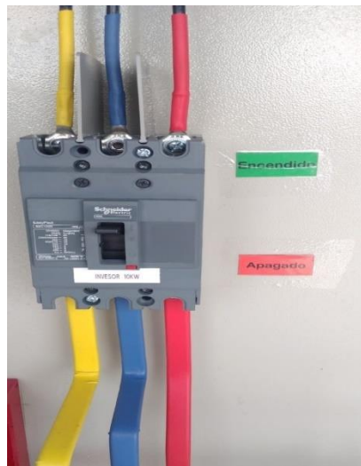
Ilustración 36 Protección del inversor de 10kWp
