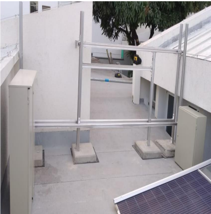
Ilustración 67 Estructura para fijar los gabinetes y equipos inversores.
