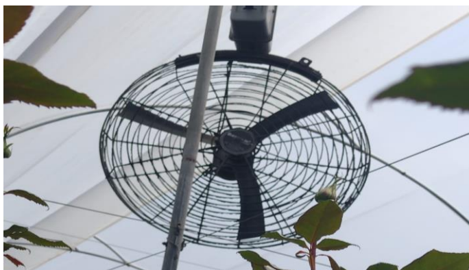
Figura 3 Ventilador breezer-36. Autoría
