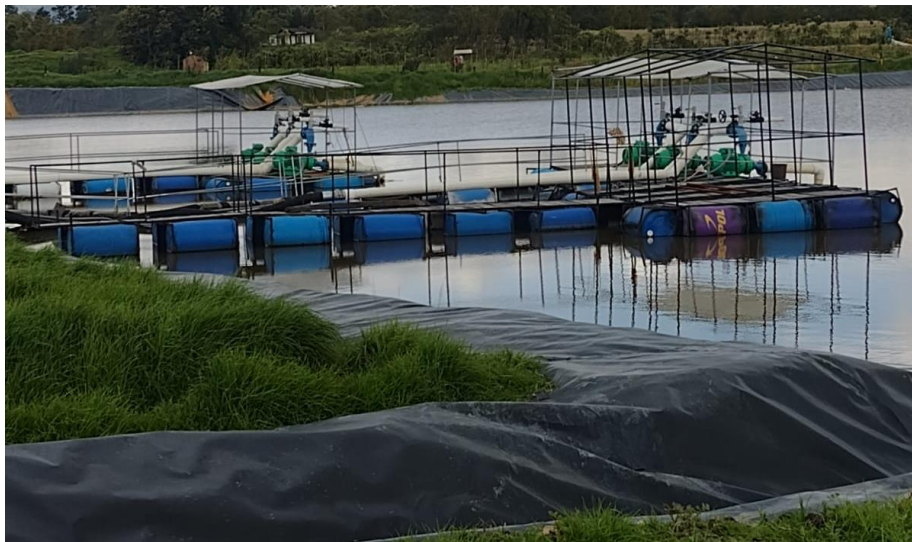
Figura 8 Unidad de bombeo. Autoría.
