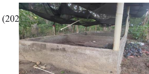
Imagen 4: Infraestructura de lombricultura en mal estado Vega (2023).
