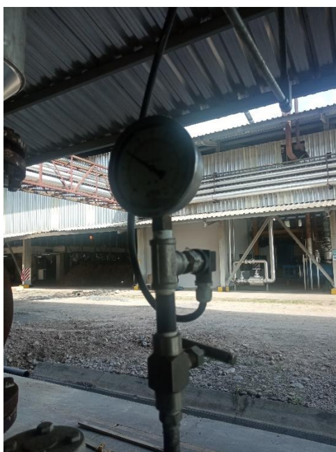
Figura 10. Transmisor de presión instalado. Registro fotográfico
