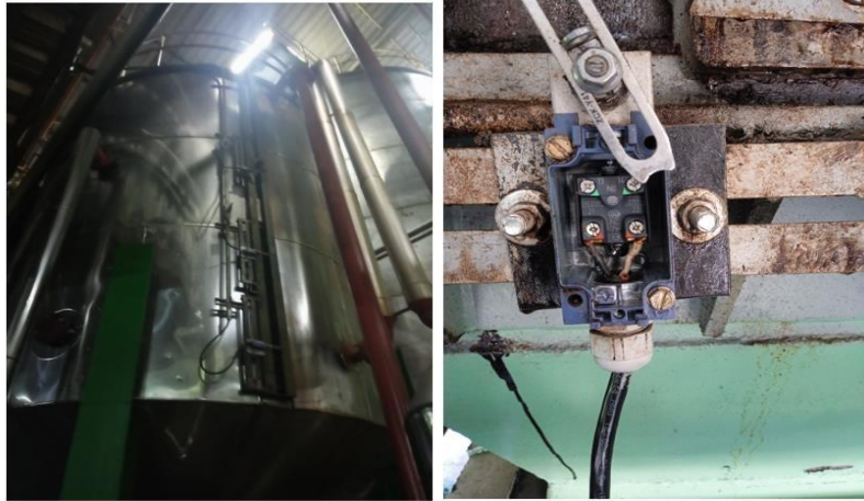
Figura 13. Izquierda: Tanque sedimentado. Derecha: Sensor final de carrera. Registro fotográfico.
