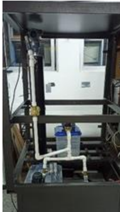
Fig. 35. Ensamble del sistema de tuberías y tanques. Fuente: Autor.
