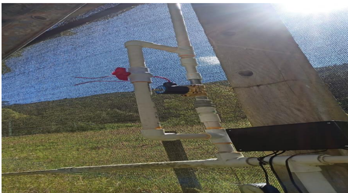
Anexo F. acople para activación manual del sistema
