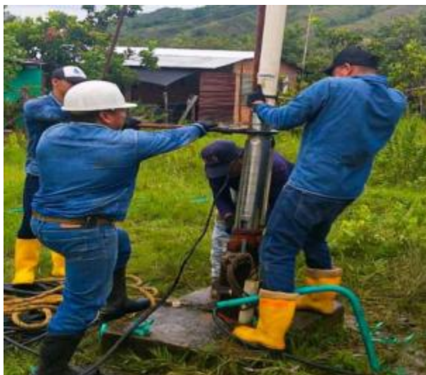
Figura 26. Instalación electrobomba sumergible tipo lapicero
