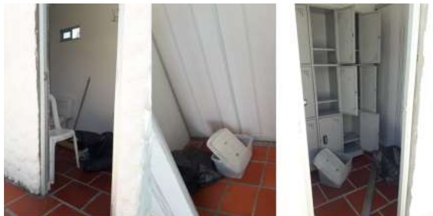
Figura 1. Unidad Sanitaria no funcional. Fuente: Avícola California. Autor: Niurka Alvarez
