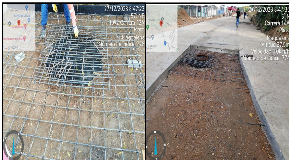
Ilustración 38. Acero de refuerzo en tapa manjoles.
