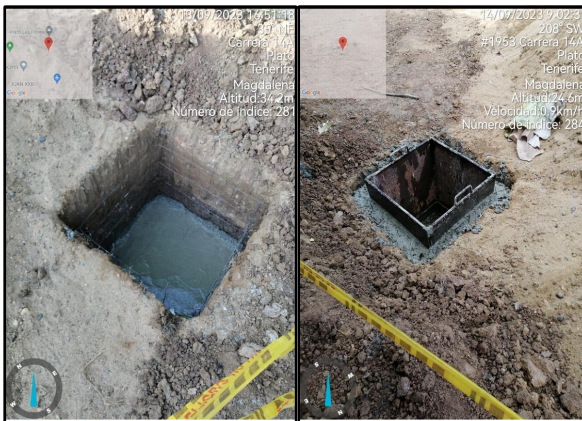
Ilustración 27. Cajas de inspección.
