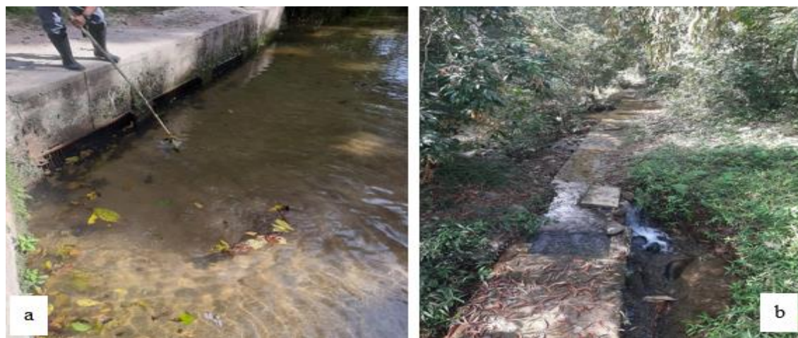
Figura 6. Bocatoma, rejillas (a) y canal de derivación (b)
