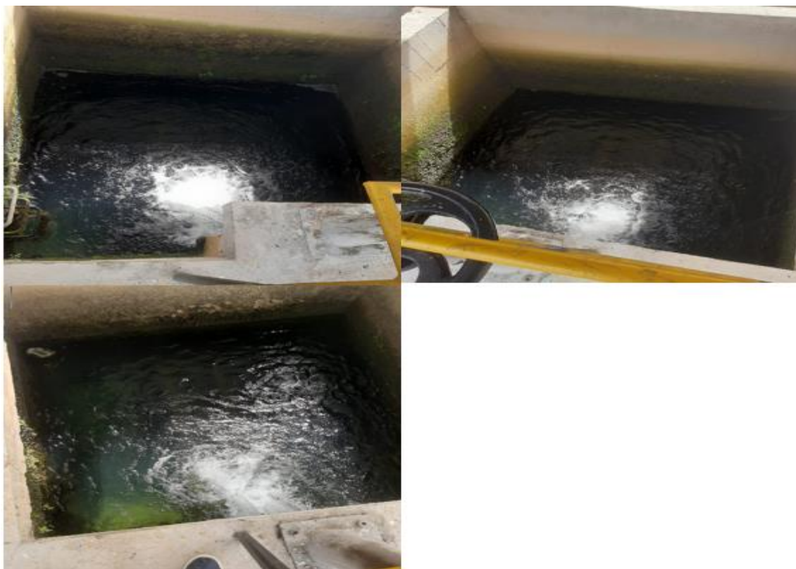
Figura 12. Tanques de filtración
