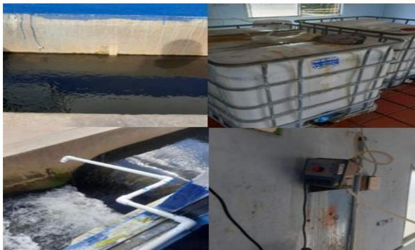
Figura 2. Vertedero, isotanques del PAC, dosificador
