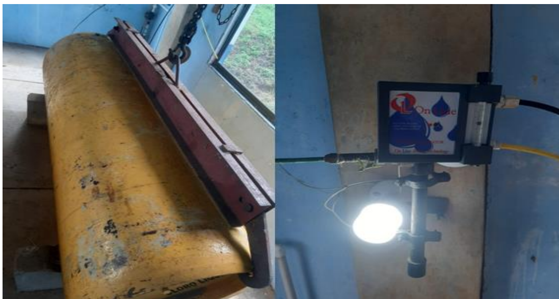
Figura 6. Sistema de cloración
