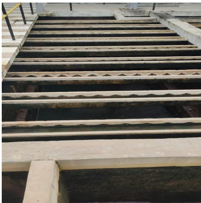
Figura 10. Tanque sedimentador (sin módulos)
