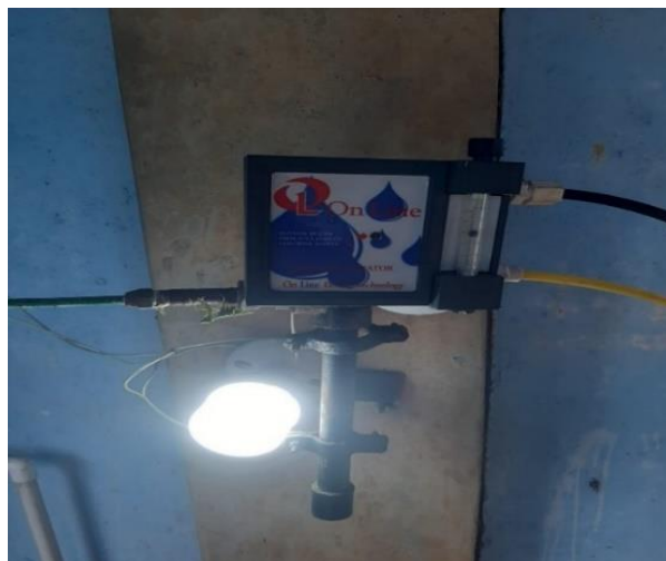
Figura 14. Dosificador de cloro.
