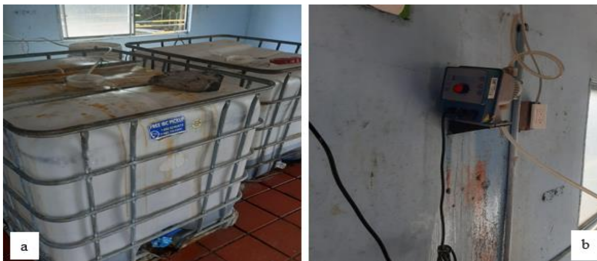
Figura 7. Isotanques de coagulante (a), sistema de bombeo(b).
