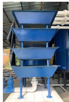
Figura 21. Torre de aireación.
