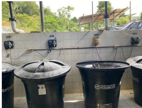
Figura 25. Inyección de cloro.
