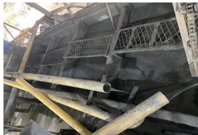
Figura 7. tanque de almacenamiento de las salidas de las celdas de flotación.
