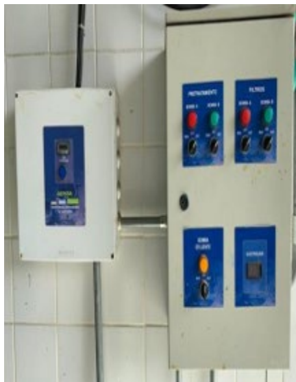
Figura 18. Tablero de bombas.
