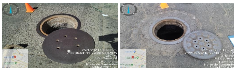
Ilustración 46 Tapa de concreto con aro metálico de los pozos de inspección
