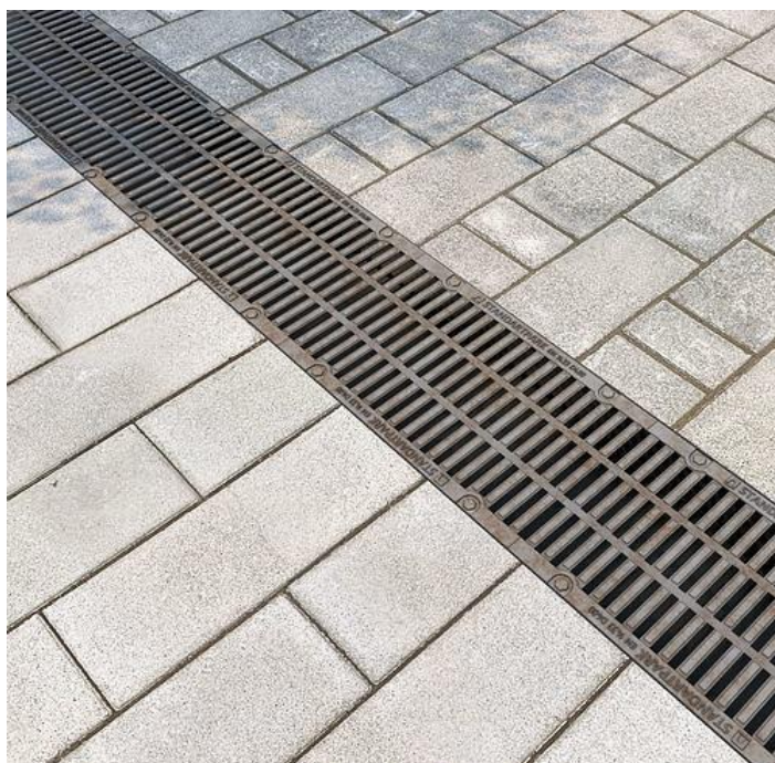
Ilustración 19. Canal de drenaje con rejilla.
