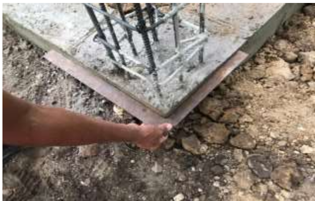
Viga totalmente a escuadra.
