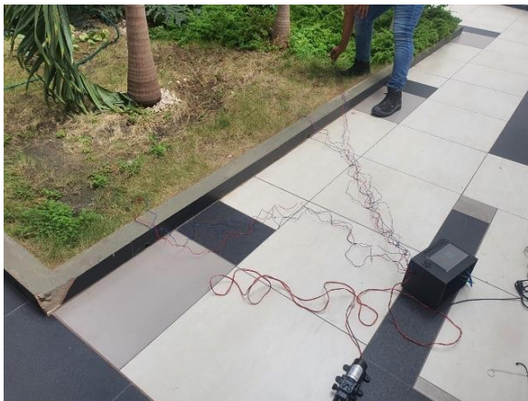
figura 88 Instalación de los sensores para someterlos a condiciones reales
