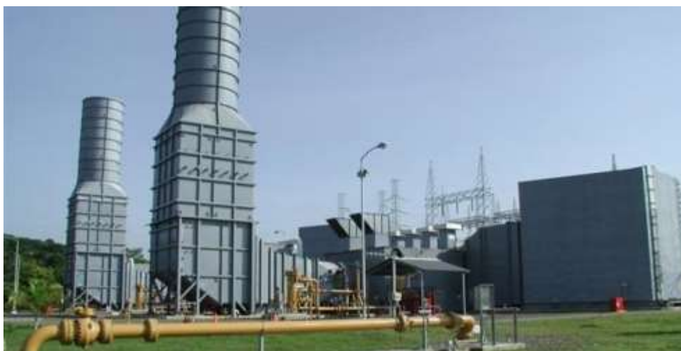
Imagen 23 Central Termoeléctrica Cartagena
