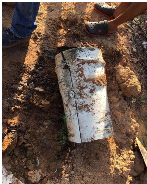
Ilustración 17 Daño en la tubería por aplastamiento, fuente propia
