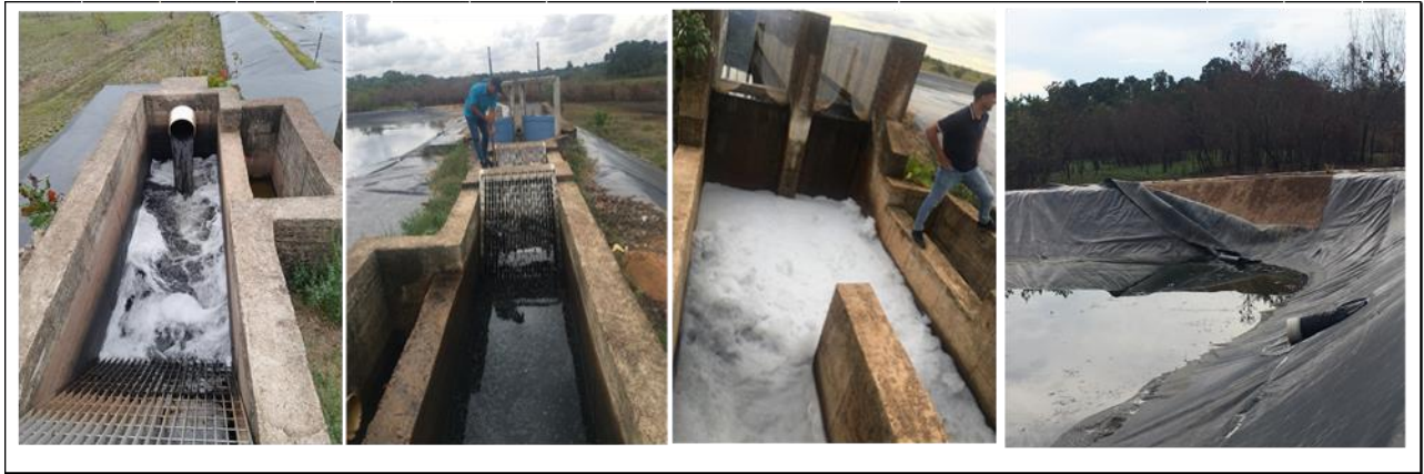
Ilustración 14 tratamiento en la PTAR, fuente propia.
