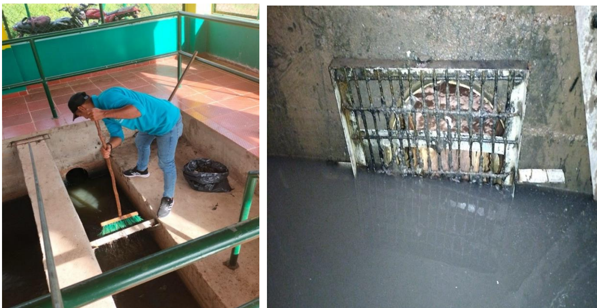
Ilustración 12 limpieza de rejillas de cribado, fuente propia
