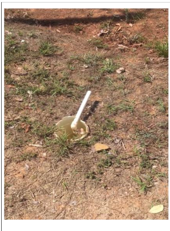
Ilustración 13 Ventosas de Aire, Fuente Propia
