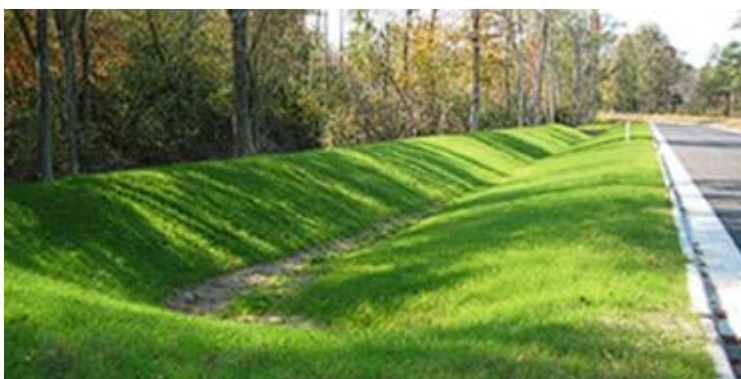
Imagen 12, cuneta verde en Bogotá (Sistemas de drenaje urbano sostenible, s. f.)
