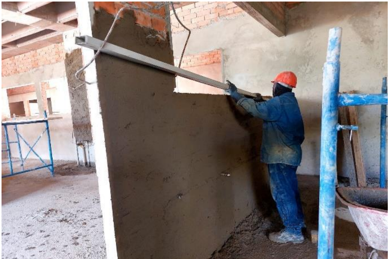
Ilustración 28 Pañete impermeabilizado muros internos Fuente: Recurso propio.
