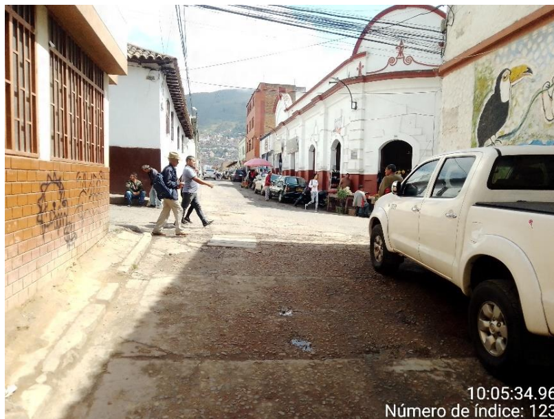
Figura 28 Carrera 5 con Calle 7, Ausencia de Señales
