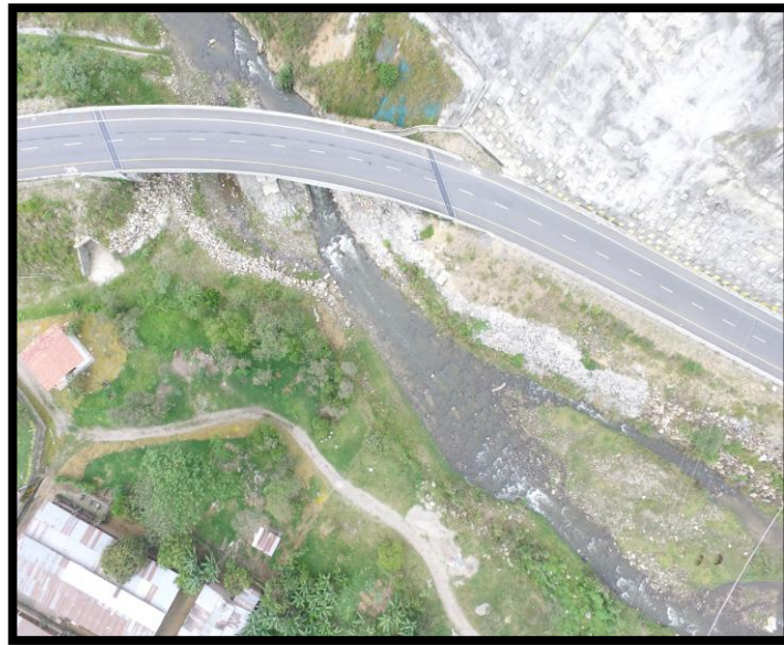
Figura 8. Imagen aérea del puente vehicular sobre el río Pamplonita, donde se evidencian intervenciones en los márgenes y acumulaciones de material en el cauce. Elaboración propia.
