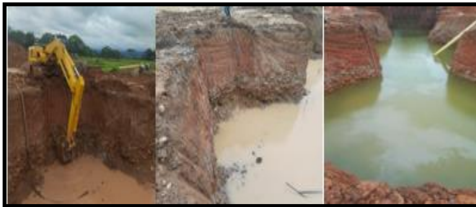
Figura 50. Nivel freático en las excavaciones de los reactores. Fuente: propia.
