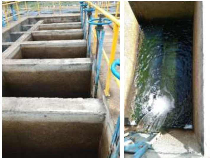
Ilustración 24. Módulos de Filtración
