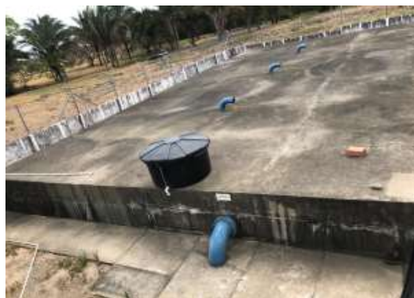
Ilustración 26. Tanque de Almacenamiento
