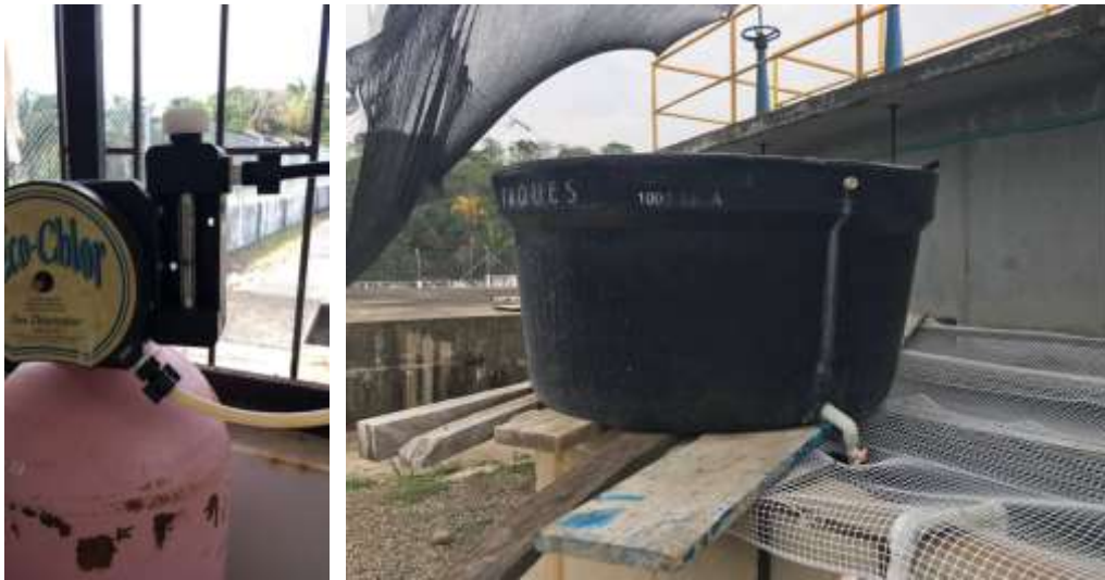
Ilustración 25. Proceso de Cloración
