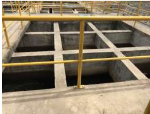
Ilustración 22. Cámaras de Floculación
