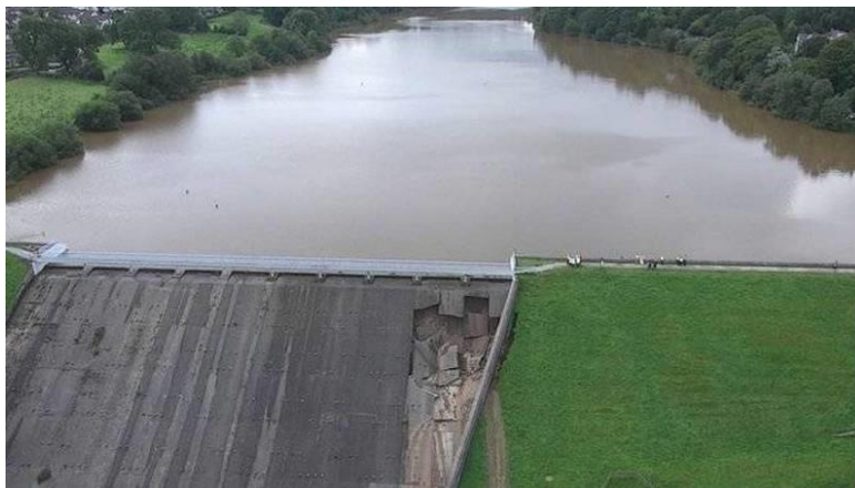
Ilustración 13 Inundación por Rompimiento de Presa
