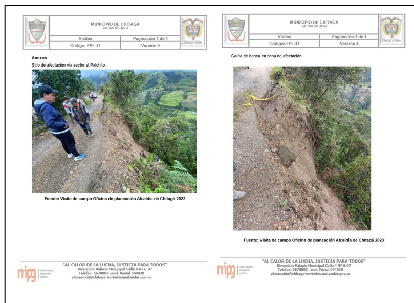
Ilustración 75. Deslizamiento y pérdida de banca en el sector el Palchito. Fuente oficina de planeación Chitagá.
