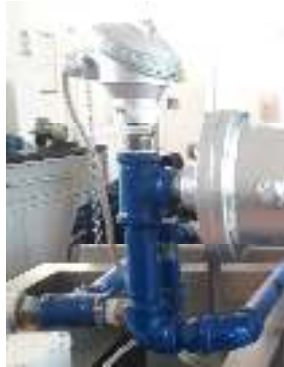
Ilustración 17 Sensor PT100 Entrada De Sistema De Coraza En Intercambiador De Temperatura.
