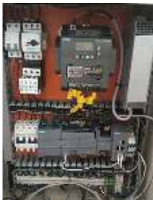
Ilustración 31 Modulo De Control.
