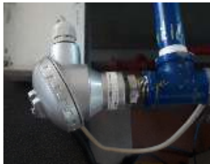
Ilustración 18 Sensor PT100 Salida De Sistema De Coraza En Intercambiador De Temperatura.
