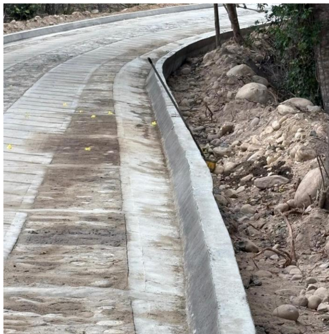
Figura 34. Evidencia de bordillos fuera de alineación
