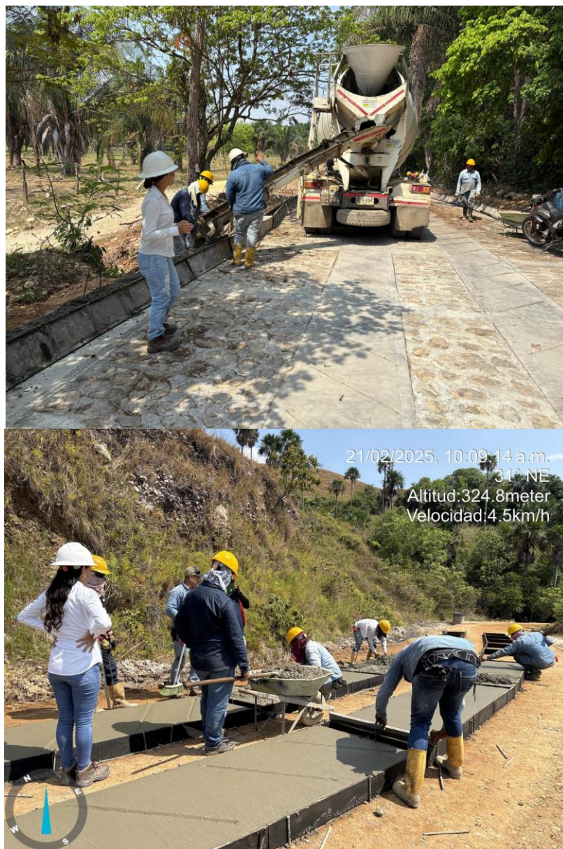
Figura 27. Evidencia control de fundida de elementos de placa huella
