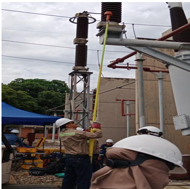
Ilustración 21 detectar si equipo esta energizado mediante el detector de ausencia de tensión
