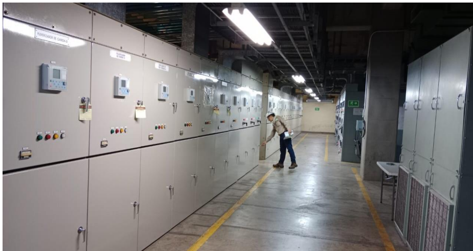
Ilustración 18 centro control de motores
