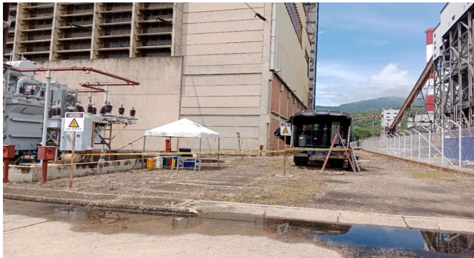
Ilustración 20 señalización de la zona de trabajo mantenimiento de trasformador Mitsubishi
