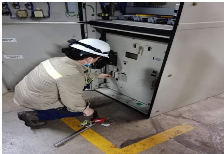
Ilustración 19 verificación en centro de control motores
