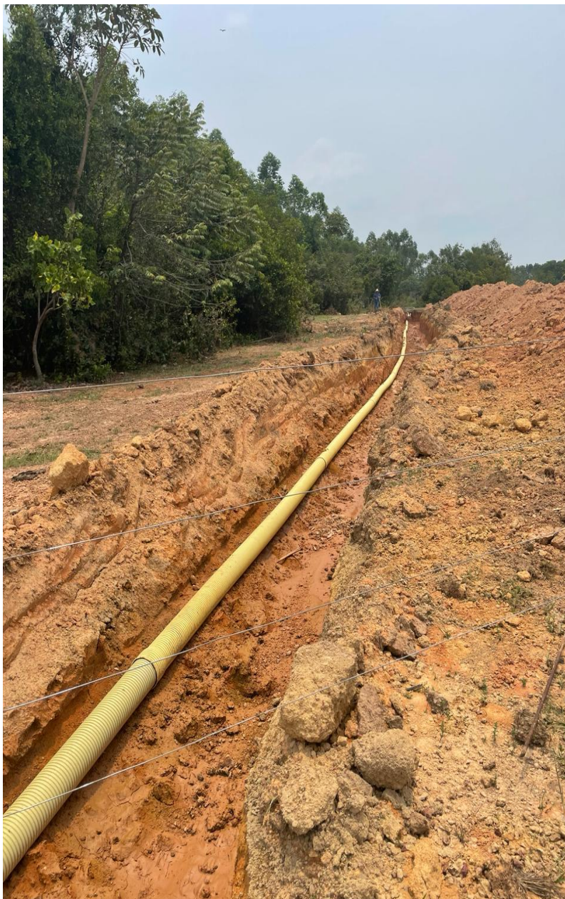
Ilustración 43 Reajuste de pendiente tubería de transporte de efluentes porcícolas
