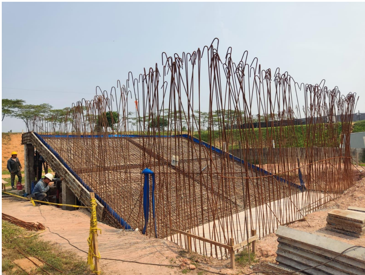
Ilustración 36 Visita Técnica - Decantador, predio Frigorífico
