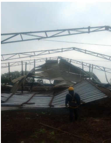
Ilustración 41 Visita técnica - caída de cubierta
