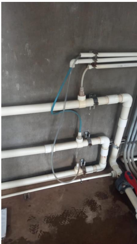
Ilustración 24 Sistema de dosificación
