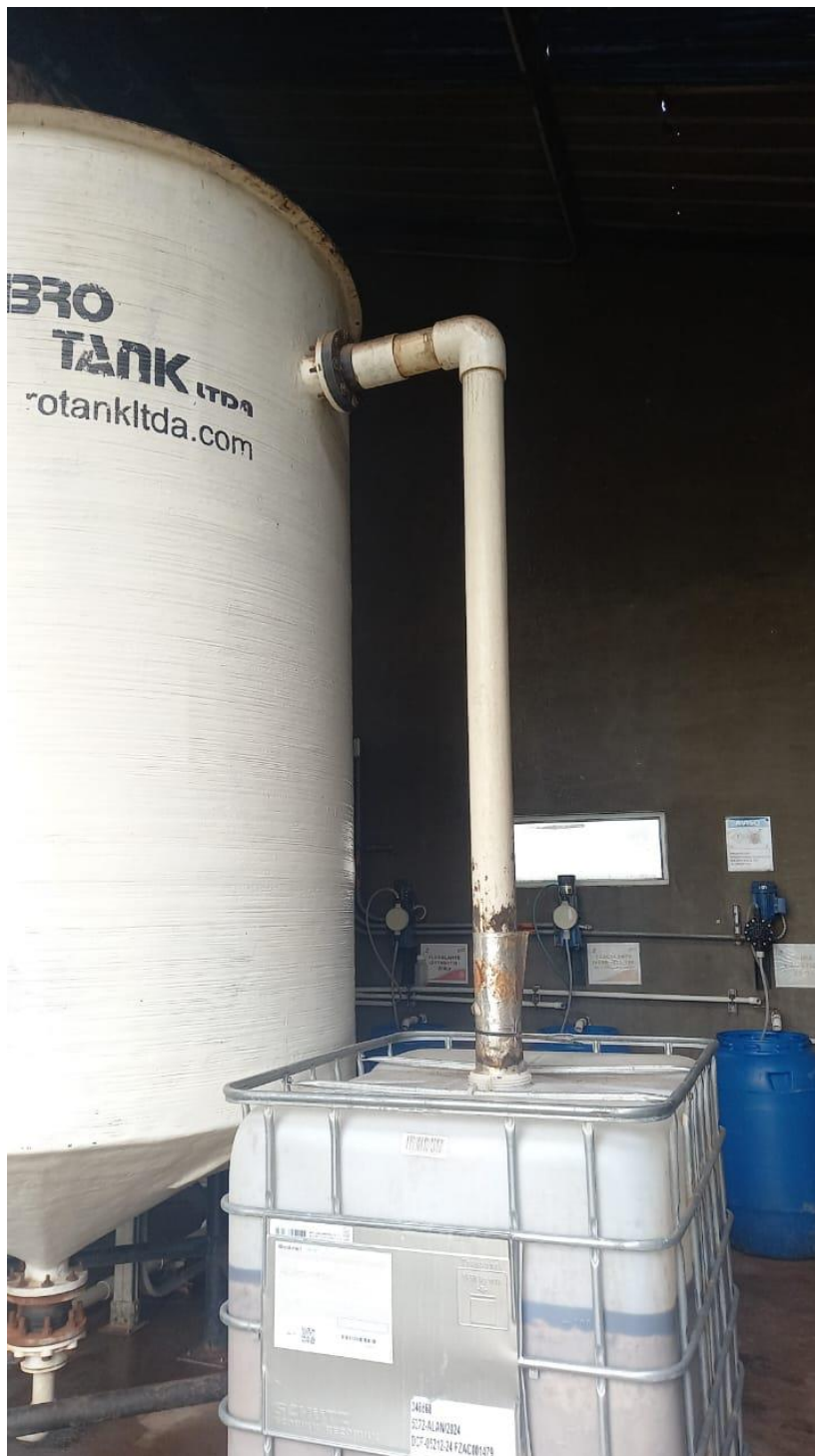
Ilustración 28 Tanque de almacenamiento - descargue de grasas
