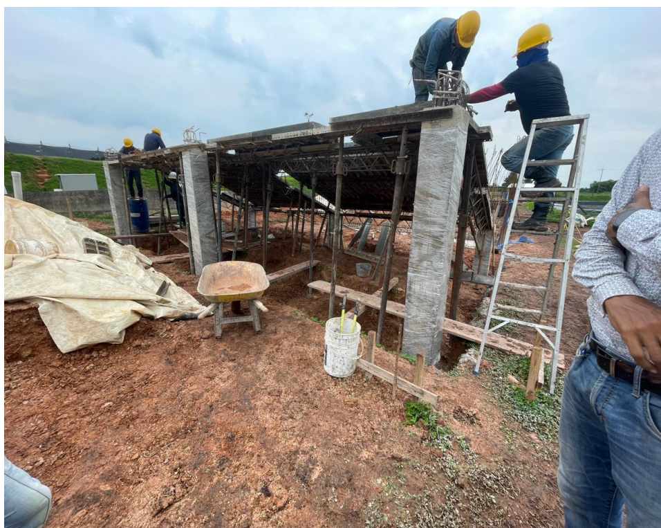
Ilustración 35 Visita Técnica - Decantador, predio Frigorífico
