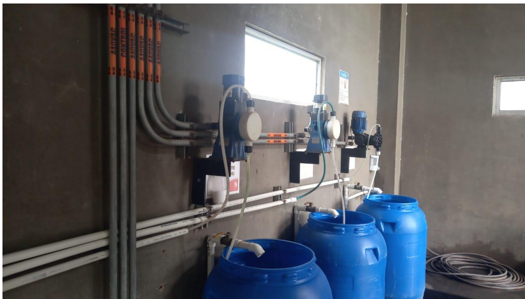
Ilustración 25 Sistema de dosificación
