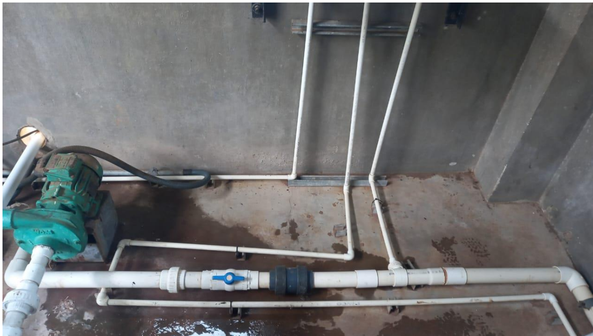
Ilustración 26 Tubería de conducción tanque de almacenamiento
