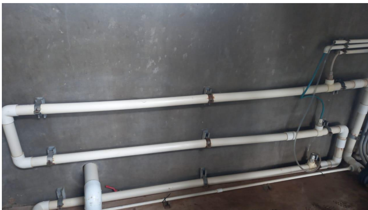
Ilustración 27 Tubería de conducción tanque de almacenamiento
