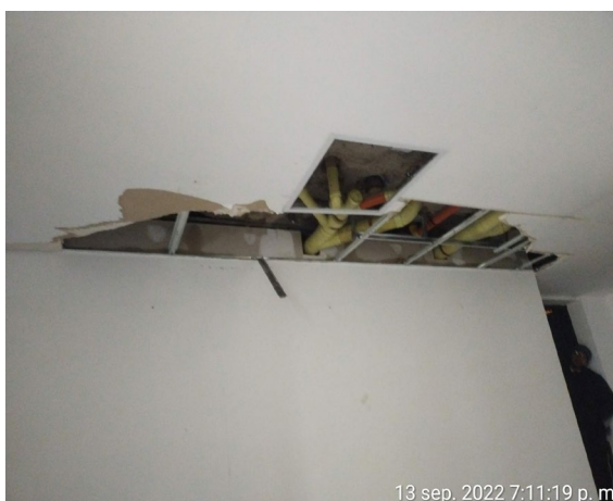
Ilustración 59 Afectación en cielo raso de la primera planta del Icetex por rotura de la tubería. Fuente: Propia.
