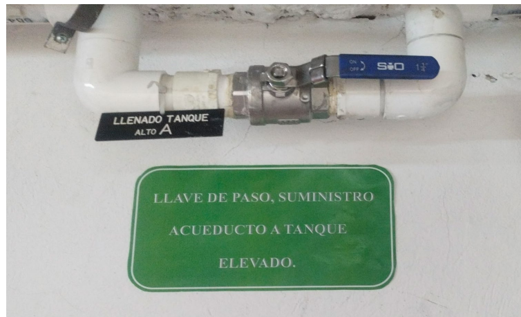
Ilustración 68 Señalización de las áreas importantes para realizar el cierre de válvulas. Fuente: Propia.
