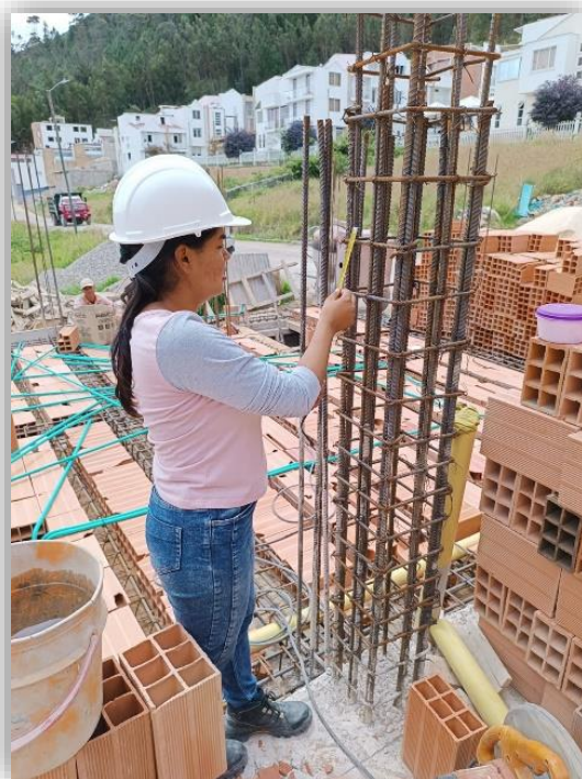
Ilustración 12 Revisión de espaciamento en flejes así como oxidación de acero corrugado
