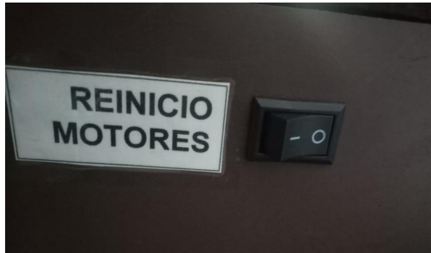
Ilustración 6.11: Interruptor para Reinicio de Actuadores del brazo (Art 3, 4, 5 y 6): Fuente: Autor.
